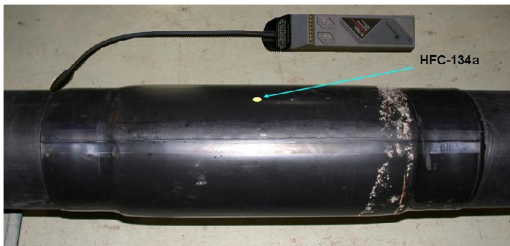
Bild 11. Läckagedetektering i skarvförband Elektronisk sniffer och hål för spårgasinjektion. Electronic sniffer and hole for trace gas injection.
