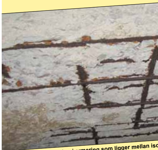
Figur 23: Exempel på armeringskorrosion.
