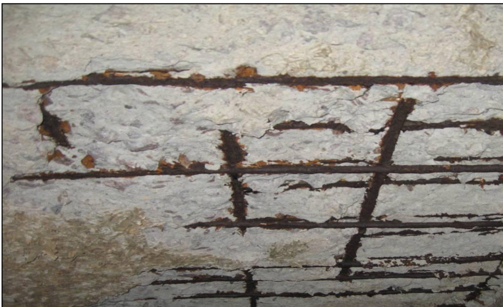
Figur 24: Exempel på korrosion i armering som ligger mellan isolering och betong.
