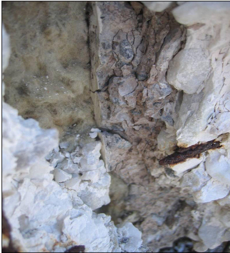
Figur 28: Frostskadad hårdnad betong.
