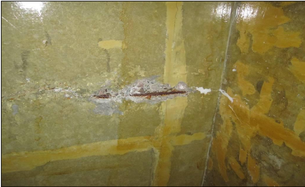
Figur 23: Exempel på armeringskorrosion.
