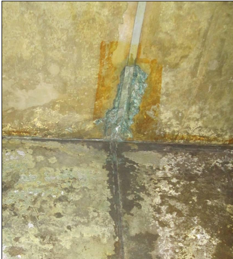
Figur 31: Här har betongen förlorat sin hållfasthet lokalt i anslutning till en dilatationsfog till följd av läckage.
