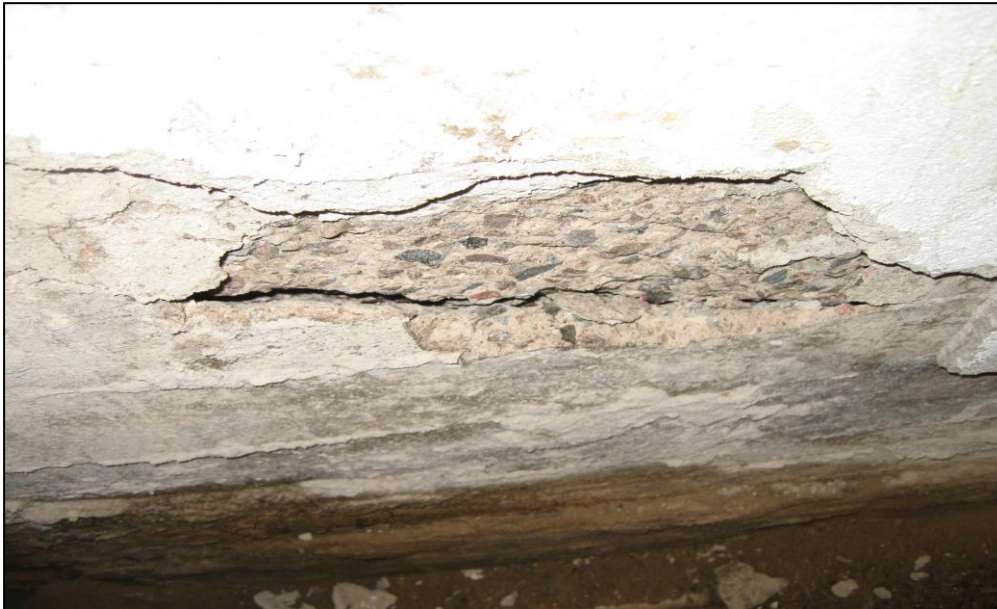
Figur 25: Armeringskorrosion som har orsakat att en större yta av betongen har sprängts loss och vidhäftning saknas mellan armering och betong, ett så kallat bomparti.
