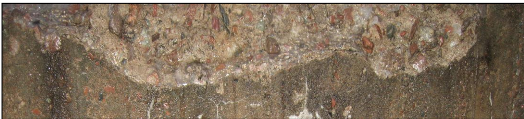
Figur 29: Frostskadad betong på ytan av en betongkonstruktion.
