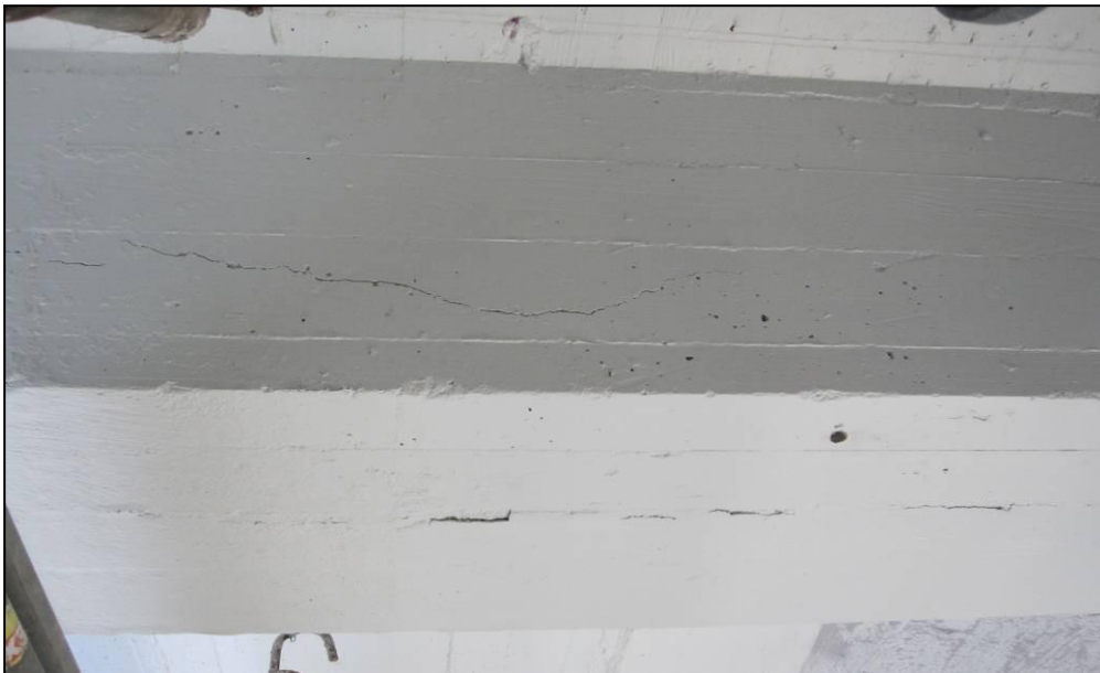
Figur 26: Spricka i betong som har orsakats av armeringskorrosion.
