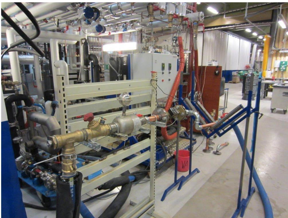
Figur 11. Provrigg för DN 40-mätare, här med dubbel böj (skruvflöde) monterad.
