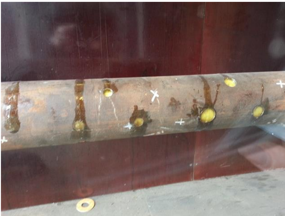
Figur 17. Relinat fjärrvärmerör med hål, observera att de mörkare zonerna inte är vatten utan gammal härdad plast från installationen, det förekommer inga som helst läckage genom strumpan.
