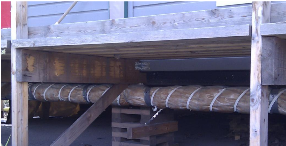
Figur 3. Tätning mellan byggbodar. Saknar dock tätning mot mark på ena sidan.
