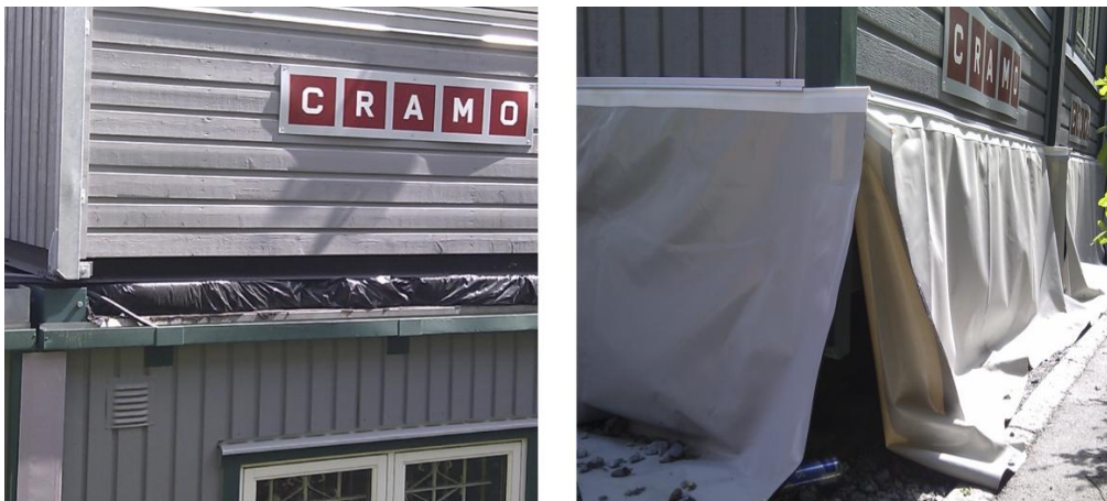
Figur 2. Tätning mellan byggbodar. Tätningen syns tydligt i den vänstra bilden där bodens svarta balk ligger an mot tätningen. Av den högra framgår att tätningen mot mark kan vara mer problematisk.
