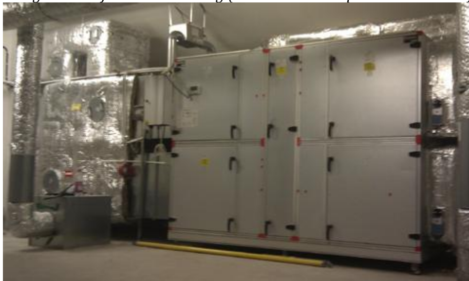
Figur 2. Centralt ventilationsaggregat på vindsplan med roterande växlare och en ozongenerator för lukteliminering (mindre låda mitt på bildens övre del).
