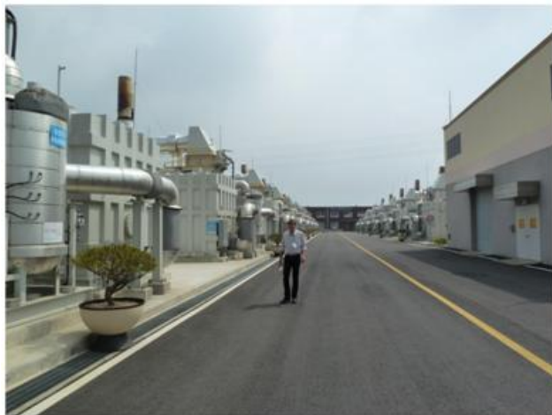
Världens hittills största bränslecellsanläggning 60 MWe i Hwasung i Korea. MCFC bränsleceller från POSCO med stackar från Fuel Cell Energy, USA
