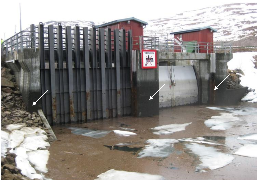
Figur 21. Överumans regleringsdamm. Frostrelaterad vittring av betongen på uppströmssidan av dammen.
