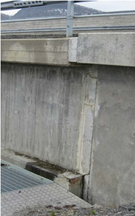
Figur 12 Sprickor i vänster fog
