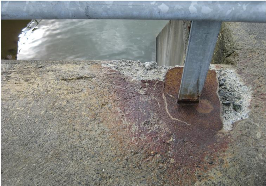
Figur 19. Överumans regleringsdamm. SprickFigurning kring stolpar i broplattan.
