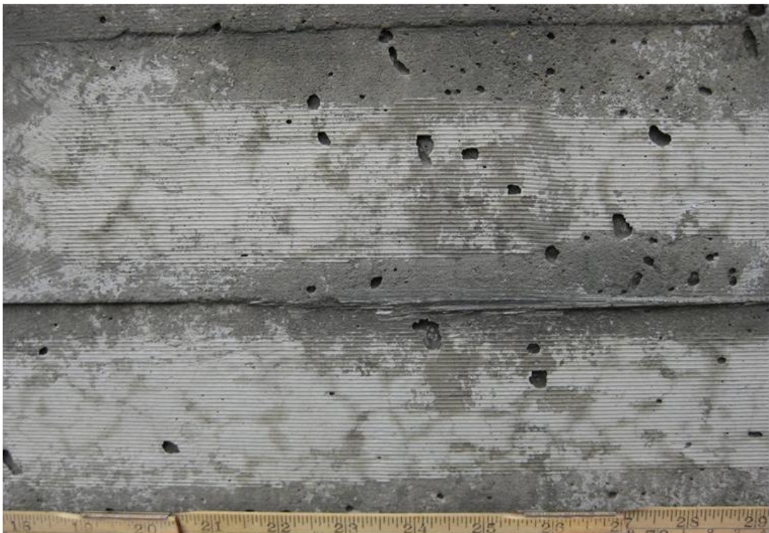
Figur 6. Ajaure. Krackeleringsmönster på betongmur till nedströms utloppskanal.
