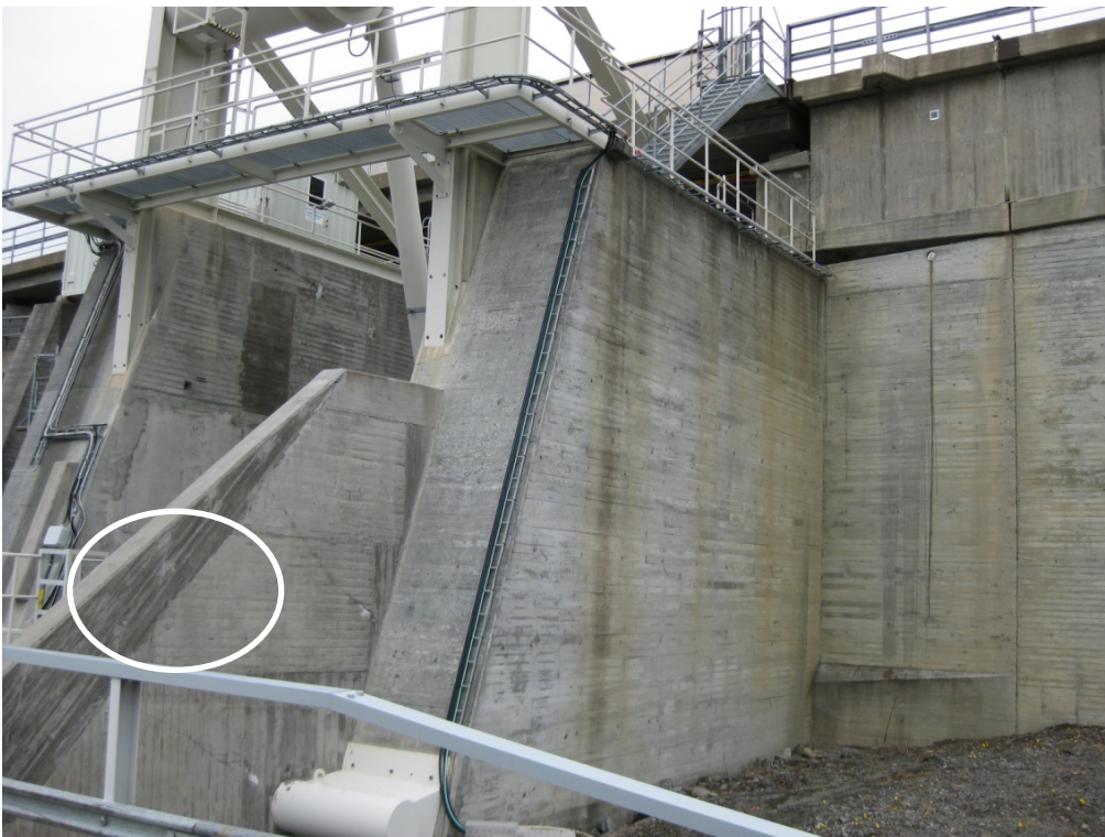
Figur 14 Vita cirkeln visar skillnaden mellan den äldre och den yngre betongen där det mörkare partiet är gjutet 2002
