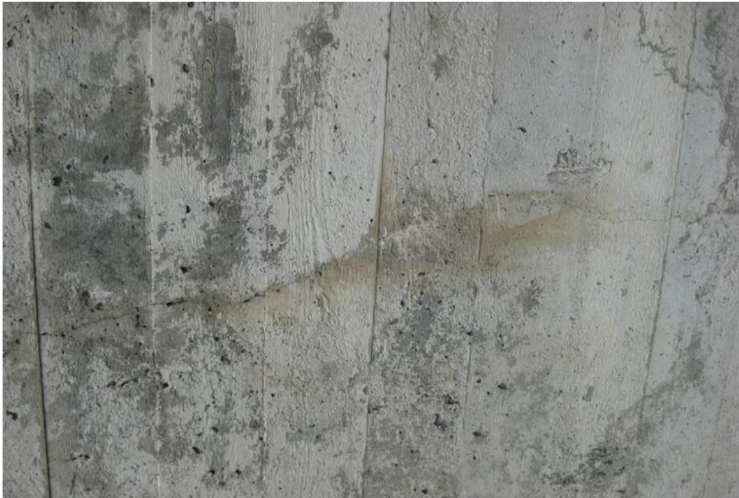
Figur 5. Ajaure. Brunaktiga utfällningar kring en spricka i betongmuren.
