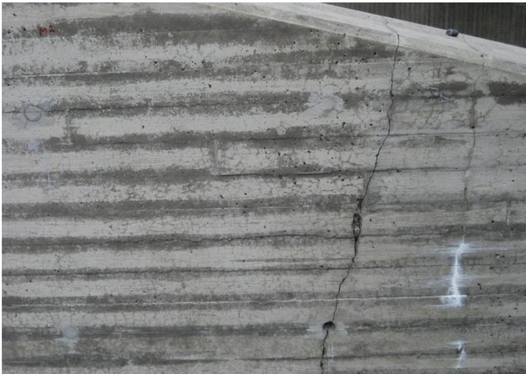
Figur 4. Ajaure. Sprickor i betongmur till nedströms utloppskanal.
