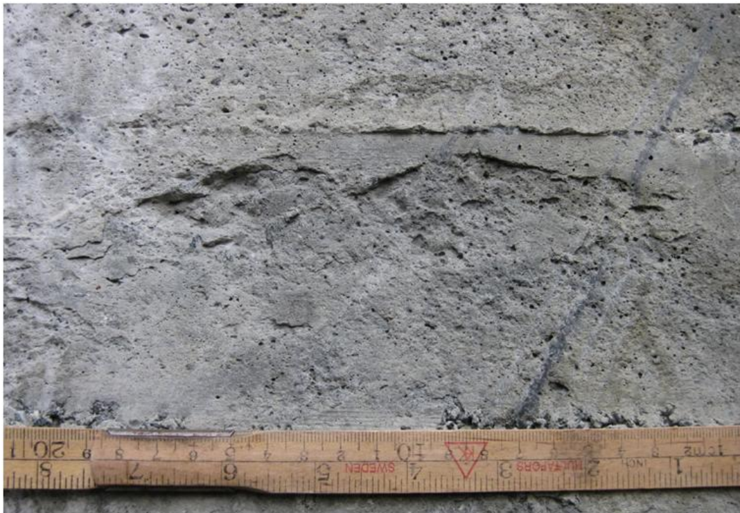
Figur 12. Gardikfors. Ytlig avskalning hos betong.
