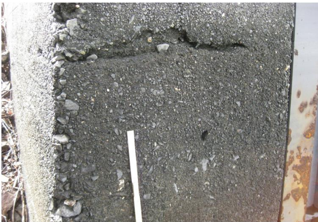
Figur 22. Överumans regleringsdamm. Närbild på vittrad betong på uppströmssidan av dammen.
