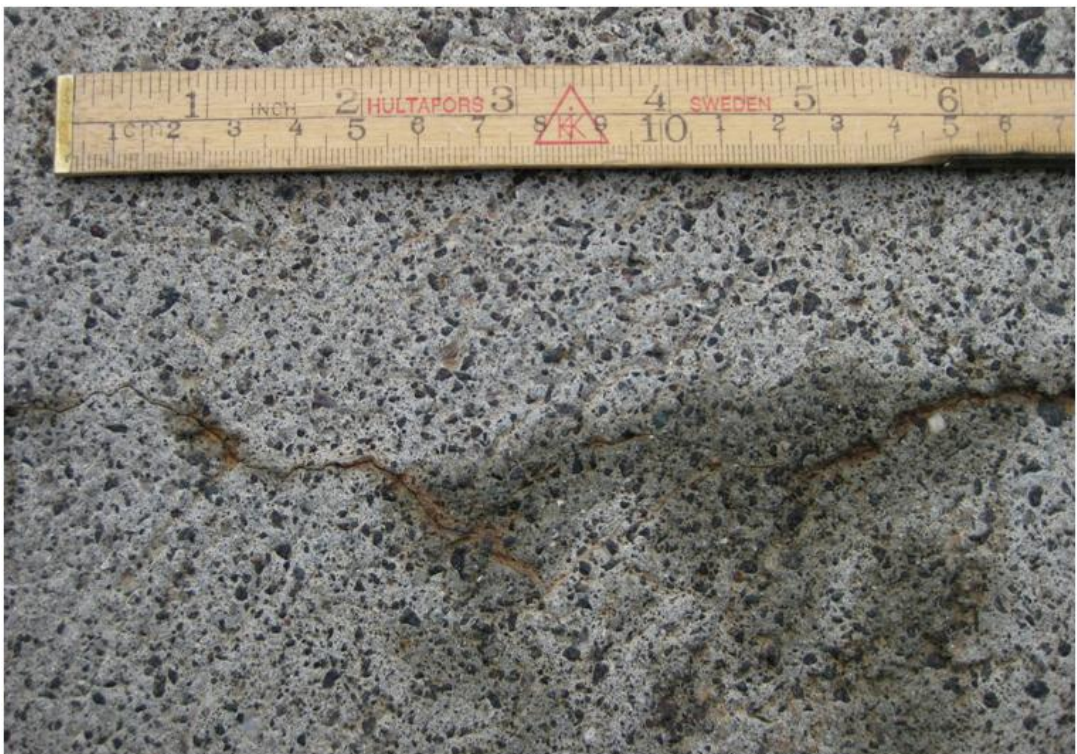
Figur 20. Överumans regleringsdamm. Brunaktiga utfällningar kring sprickor i broplattan.
