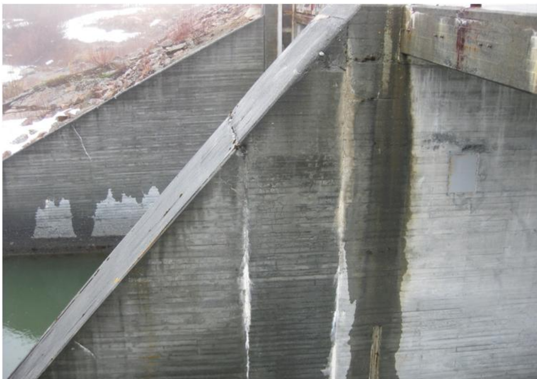
Figur 15. Överumans regleringsdamm. Utfällning av kalk längst gjutskarvar.
