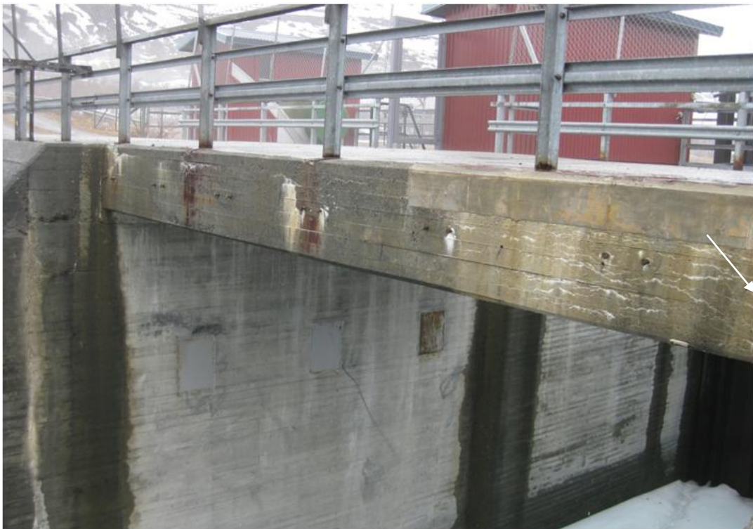
Figur 18. Överumans regleringsdamm. Sprickor och utfällningar av kalk i broplattan (se pil).
