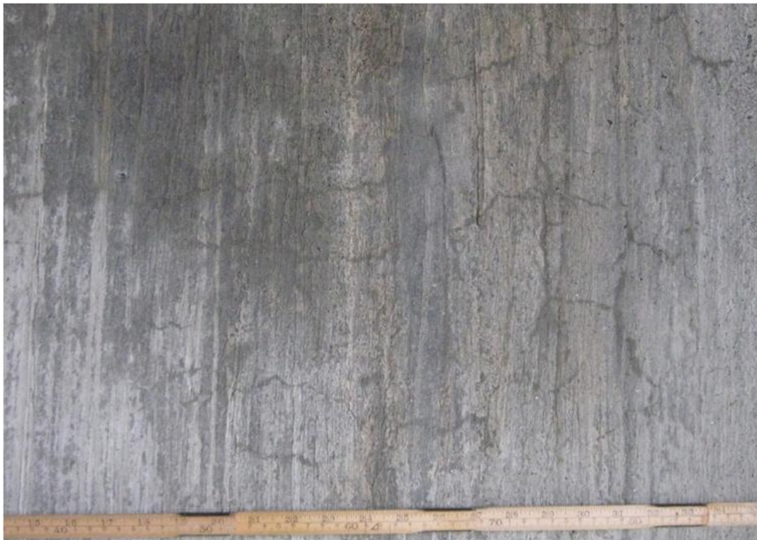
Figur 11. Gardikfors. Krackeleringsmönster på betongens yta.
