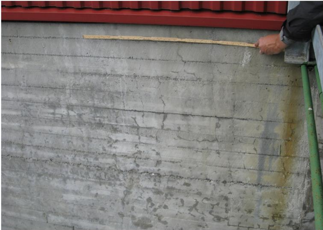
Figur 17. Överumans regleringsdamm. Krackeleringsmönster på betongens yta.
