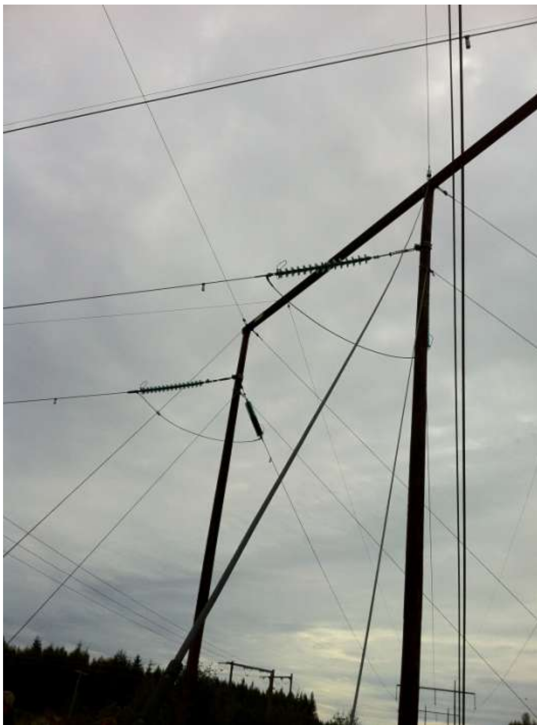
Figur 16. Trästolpe med stålstag.
