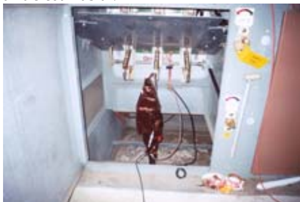
Figur 7 En skärm har skapats för att mäta mellan tre faser och jord i en trefaskabel.
