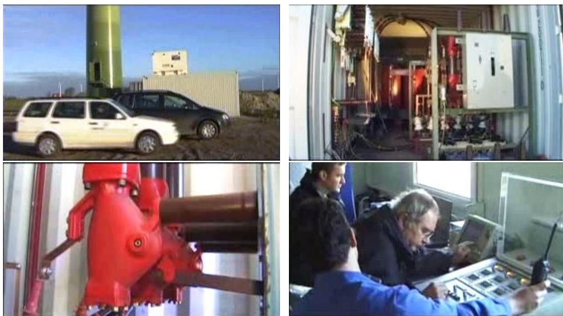
Figur 4.5 Tysk utrustning för spänningssänkningar. Överst vänster: Container med kortslutningsutrustning, kontrollrummet ovanför. Överst höger: Reaktorer och frångiljare. Nederst vänster: Frångiljare. Nederst höger: Kontrollrummet.
