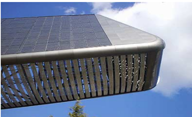
Detalj från installationen av solcellerna på Sanyo Solar Ark
