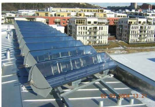
Figur 4 Översiktsbild över hybridanläggningen i Hammarby Sjästad.
