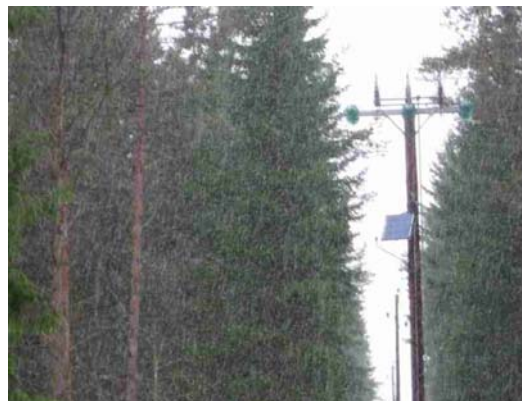
Figur 6 Exempel på soleftförsörd frångiljarstation utan reflektor
