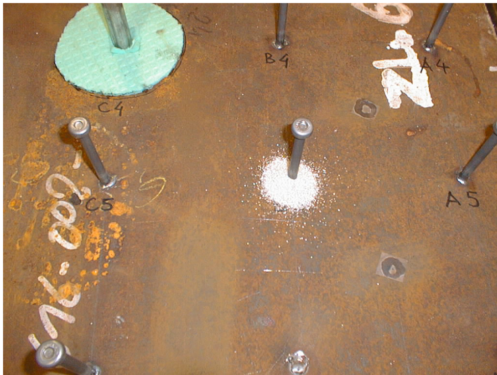
Figur 3 Simulerat rostangrepp vid infästningen av en "stud" mot stålplåten i punkt B5.
