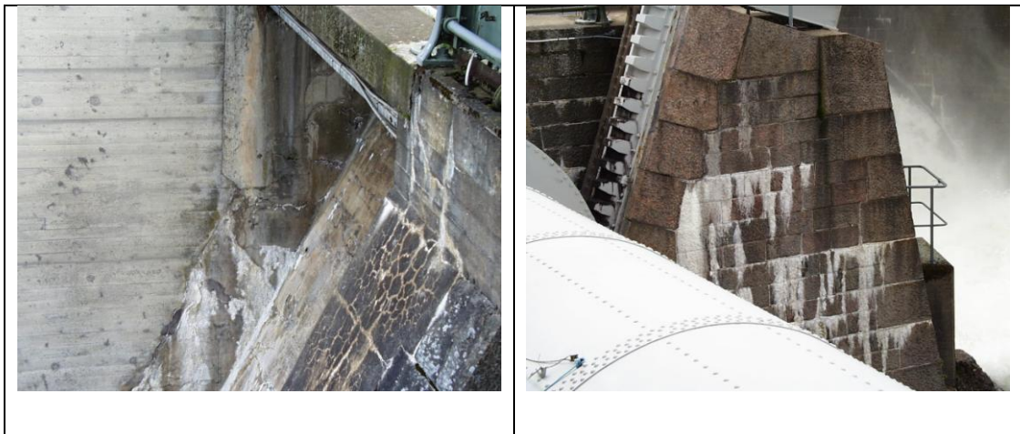
Figur 2.2 Sprickbildning och urlakning hos en gammal dammkonstruktion.
