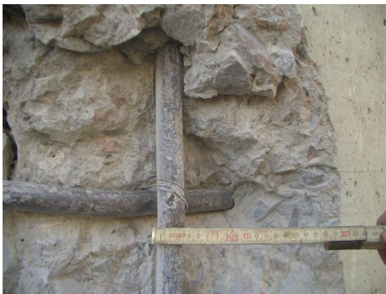
Figur 2.1 Betongen tillhörande sumpväggen är i gott skick. Betongen i figuren representerar betongens utseende över lag. Konstruktionen är armerad med 25 mm släta järn.
