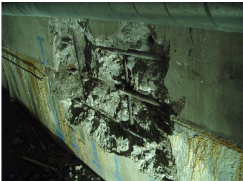
Figur 4.2 Friläggning av armering vid provyta 1 tillhörande uppströmsväggen i inspektionsgången. Friläggningen skedde på båda sidor om gjutfogen. Okulärt, kunde ingen armeringskorrosion observeras, gjutfogen var vattenförande
