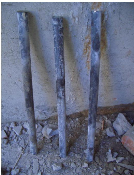
Figur 4.3 Armeringsjärn uttagna från provyta i Figur 4.2 som benämns som "Månsbo 1". Okulärt kunde ingen armeringskorrosion observeras
