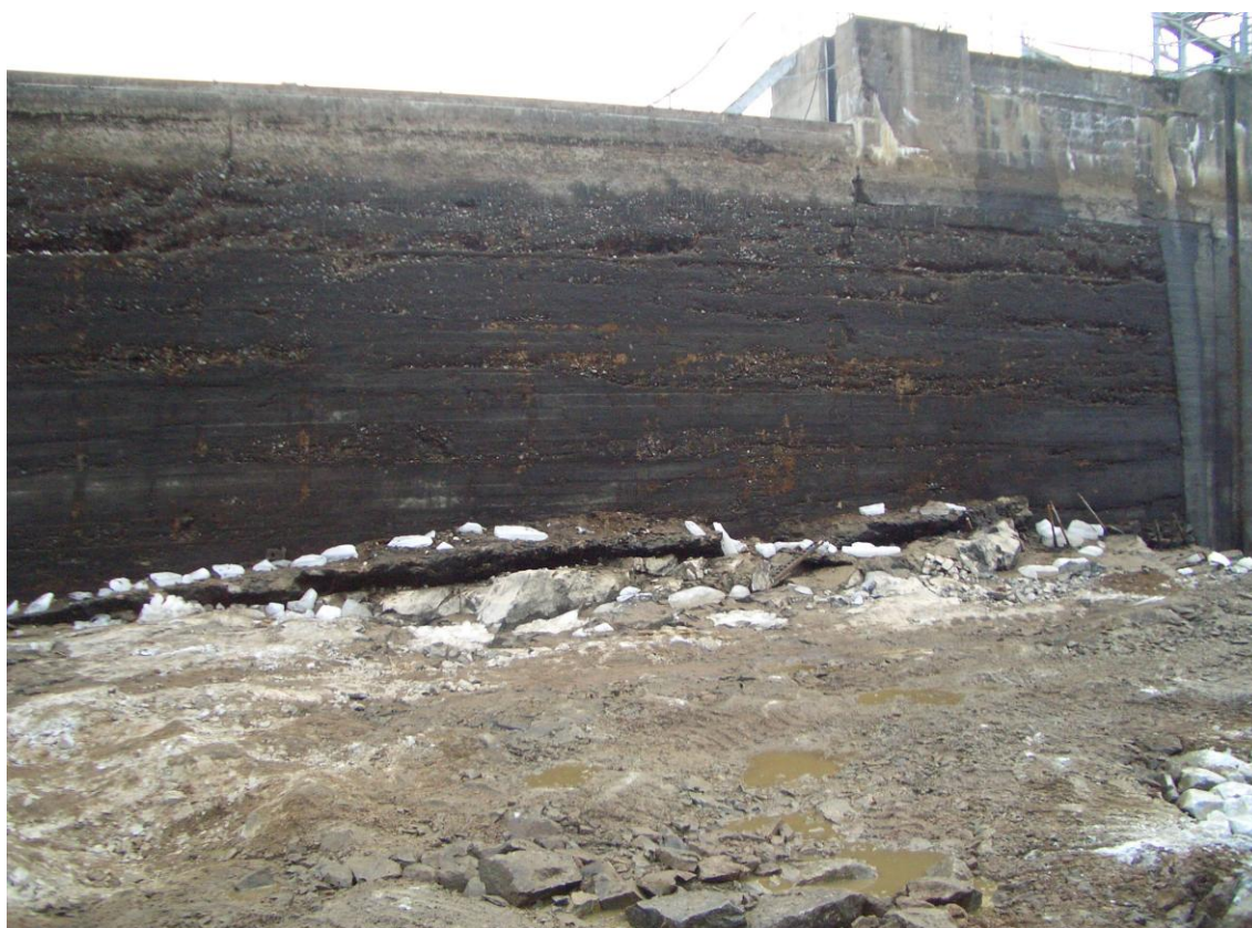
Figur 4.1. Observerade skador på en ledmur tillhörande intaget till en ovanjordsstation. Skadorna på betongen vid och under vattenlinjen synliggjordes vid tömning av intagskanalen. Skadorna ser möjligen ut att följa gjutfogar. Notera AKR angreppen belägna ovan vattenlinjen, i det övre, högra, hörnet [Foto: T. Sandström, VRD]
