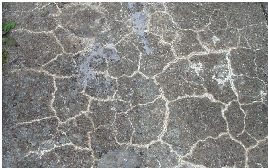
Figur 4.3 Krackelering av en yta till hörande en damm. Krackeleringen är orsakad av frost angrepp och termisk expansion [Foto: M. Hassanzadeh, LTH/VRD]
