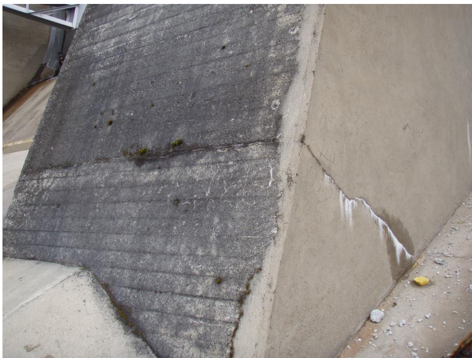
Figur 4.6 En monolitisk betongkonstruktion som har en genomgående spricka. Den bakomliggande orsaken är troligen temperaturinducerade volymförändring i kombination med tvång. Detta förlopp har orsakat en form av överlast och betongens draghållfasthet har överskridits. Pelaren har pågjutits, men bara något år senare ser vi att sprickan propagerat igenom reparationen [Foto: T. Sandström, VRD]
