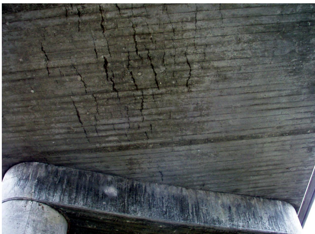
Figur 4.5 Sprickorna i figuren orsakade av AKR, av den anledningen kan de benämnas som fuktrelaterade [Foto: M. Hassanzadeh, LTH/VRD]
