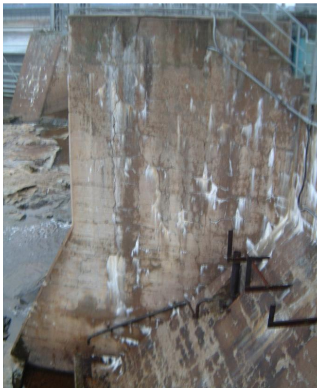
Figur 4.2. Pelare tillhörande en betongdamm som utsatts för AKR angrepp. Sprickorna som uppstått p.g.a. den inre expansionen leder till att ytterligare skademekanismer kan öka i omfattning. I figuren syns hur cement (kalciumhydroxid) urlakas konstruktionen [Foto: T. Sandström, VRD]
