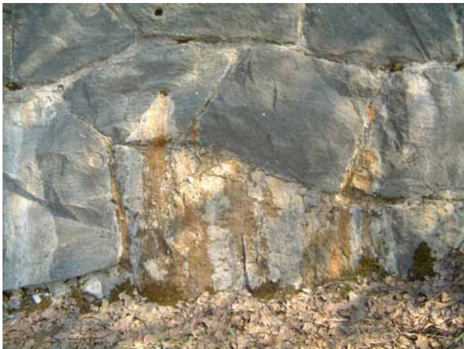
Figur 3.3 Exempel på fuktigt parti på murens utsida
