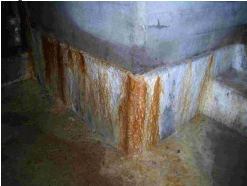
Figur 4.14 Rikligt med kalkutfällningar och eventuella korrosionsprodukter ur förmodad gjutfog i nedströms/norra väggen
