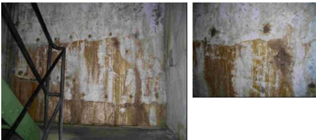
Figur 4.7 och 4.8 Vertikala och horisontella sprickor med kalkutfällningar och korrosionsprodukter som injekterats.
