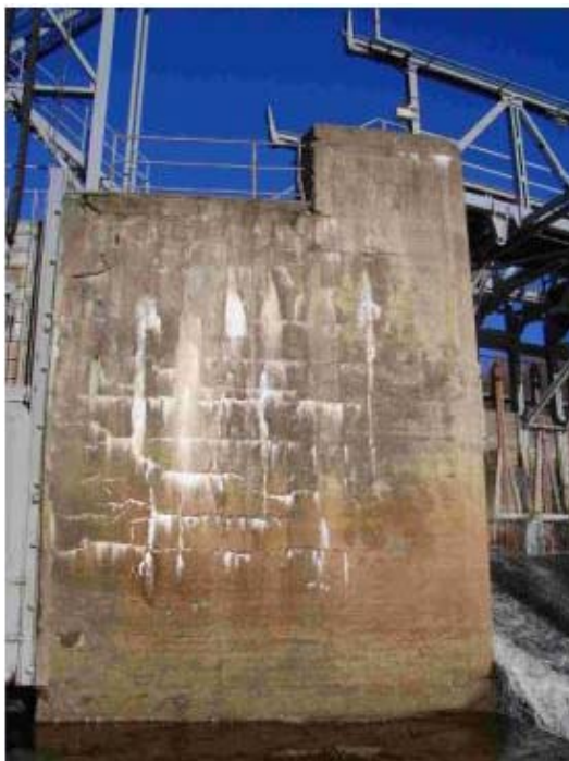
Figur 2.18 Sprickor med kalkutfällningar i pelarsida
