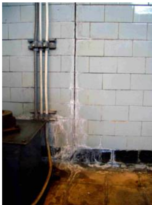
Figur 4.3 Dilationsfogen i maskinsalen, uppströms vägg. Läckage med kalkutfällningar vid golvet
