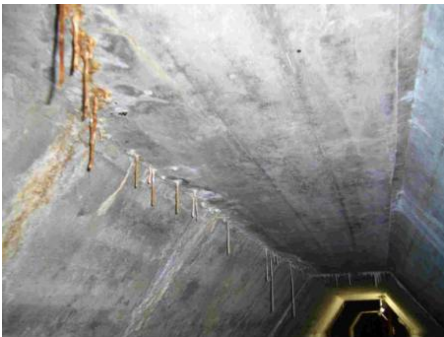
Figur 4.17 Kalkutfällningar i form av stalaktiter kommer ur gjutfog mellan snedtak och tak.
