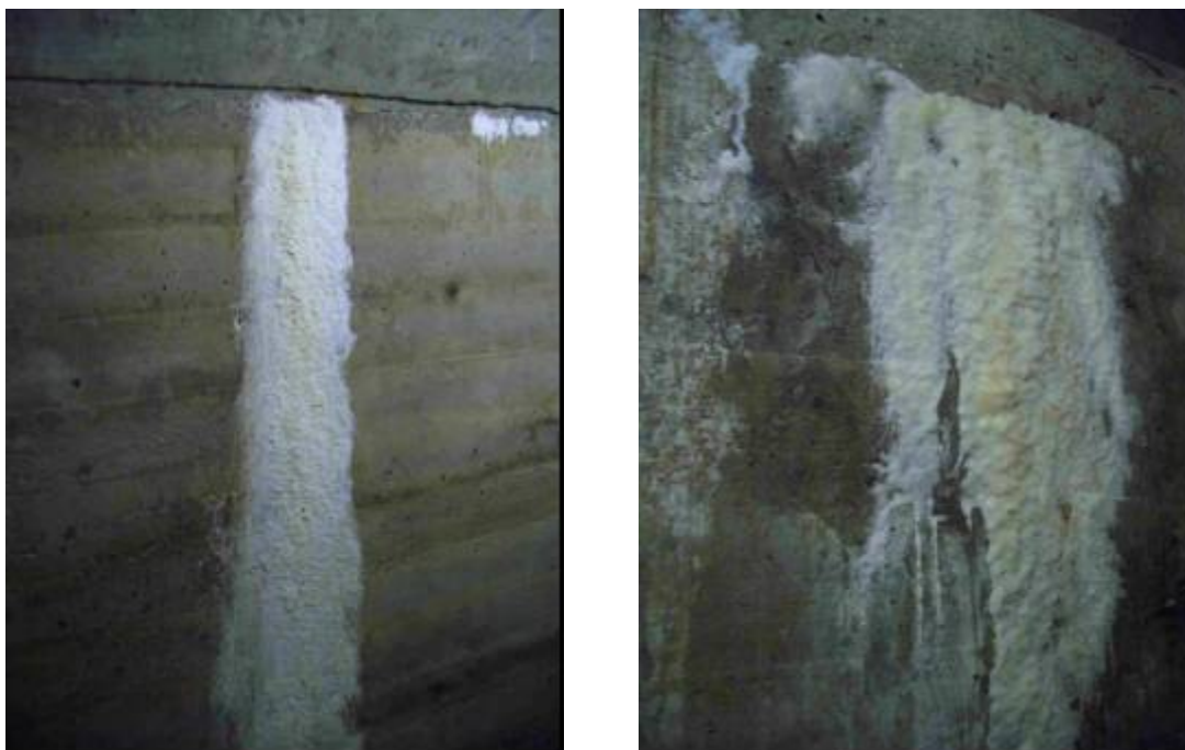
Figur 2.13 och 2.14 Exempel på kalkutfällningar från betongvägg i inspektionsgång, Månsbo kraftverk
