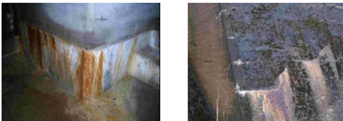
Figur 2.15 och 2.16 Sprickor med läckage, kalkurlakning och eventuellt korrosions-produkter
