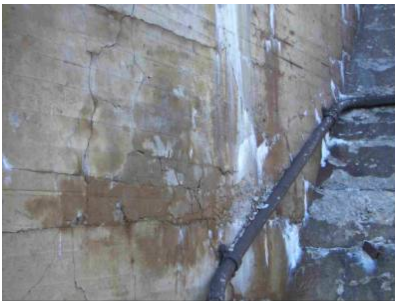
Figur 2.9 Läckage och fuktfläckar runt sprickor i betongpelare
