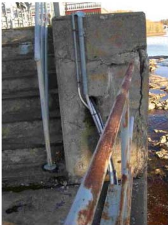
Figur 2.23 Spjälkning längs pelarkant förmodligen på grund av armeringskorrosion
