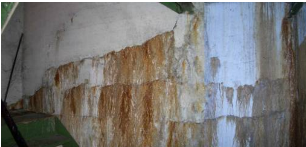
Figur 4.10 Vatten, kalkutfällningar och eventuellt korrosionsprodukter kommer ur förmodliga gjutfogar
