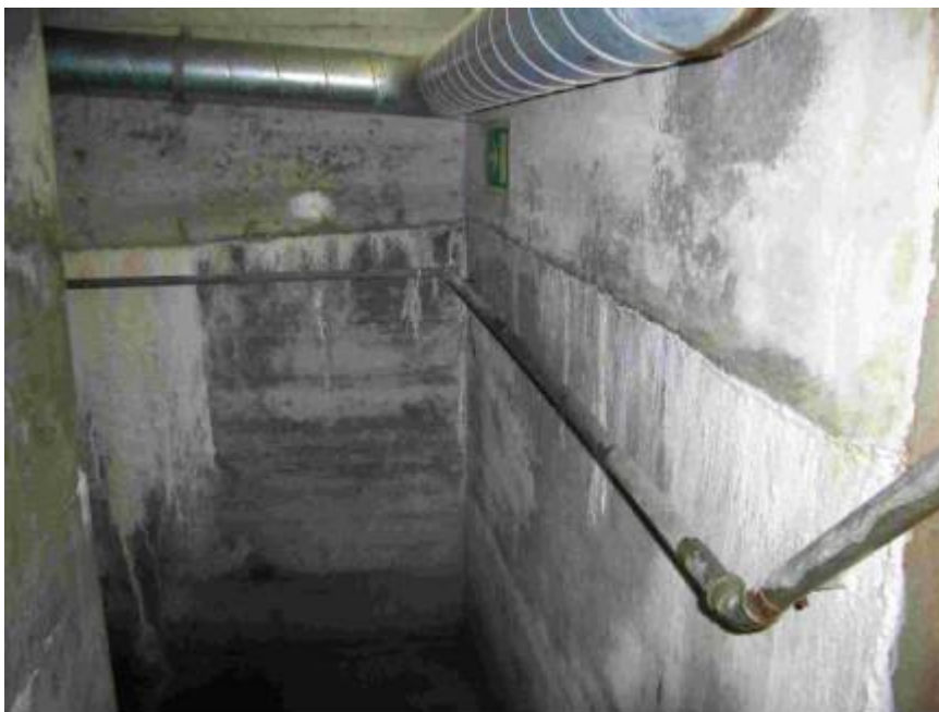
Figur 4.13 Rikligt med kalkutfällningar ur förmodad gjutfog
