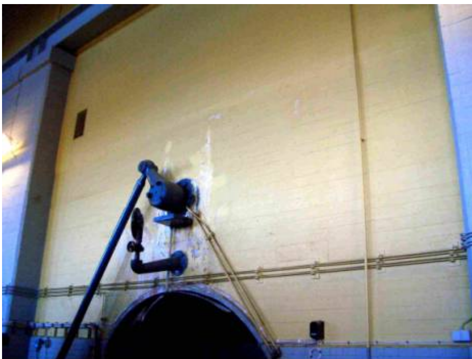
Figur 4.4 Maskinsalen uppströms vägg, system 3. Kalkutfällningar från eventuell sprickbildning samt försök till övermålning syns.
