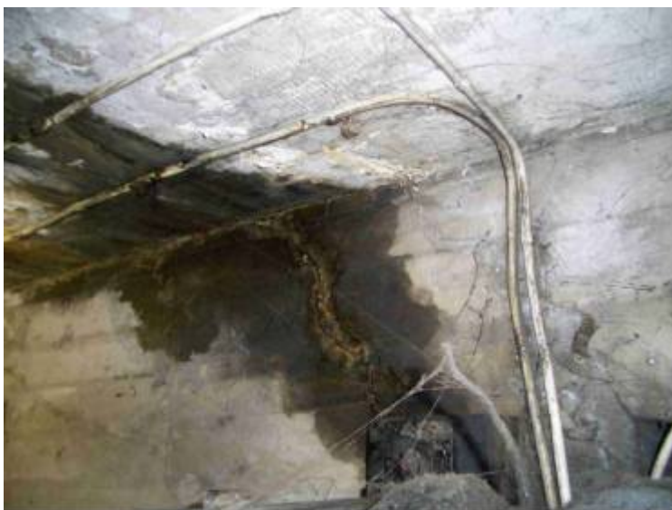
Figur 4.5 Främre inspektionsgång, uppströms vägg vid tak. Mörkare partier liknande olja syns runt sprickor.
