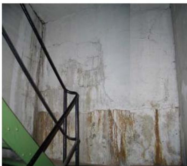
Figur 4.9 Kalkutfällningar och eventuellt korrosionsprodukter kommer från förmodliga gjutfogar. Notera att de eventuella korrosionsprodukterna främst kommer från gjutfogen ungefär i mitten av uppströmsväggen.
