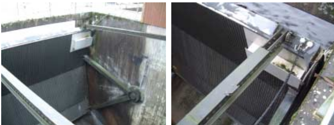
Figur 3.4 Utskovslucka med kuggstångsspel och påverkansdon på kuggstång.
