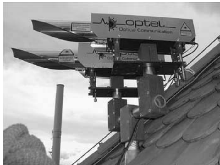
Figur 3.5 - Två laserlänkenheter uppriggade på ett tak. Källa: Direktkronik
