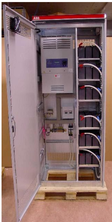
Figur 3.1 UPS-skåp med batteri för en 4 kW motor och 15 minuters drifttid.
