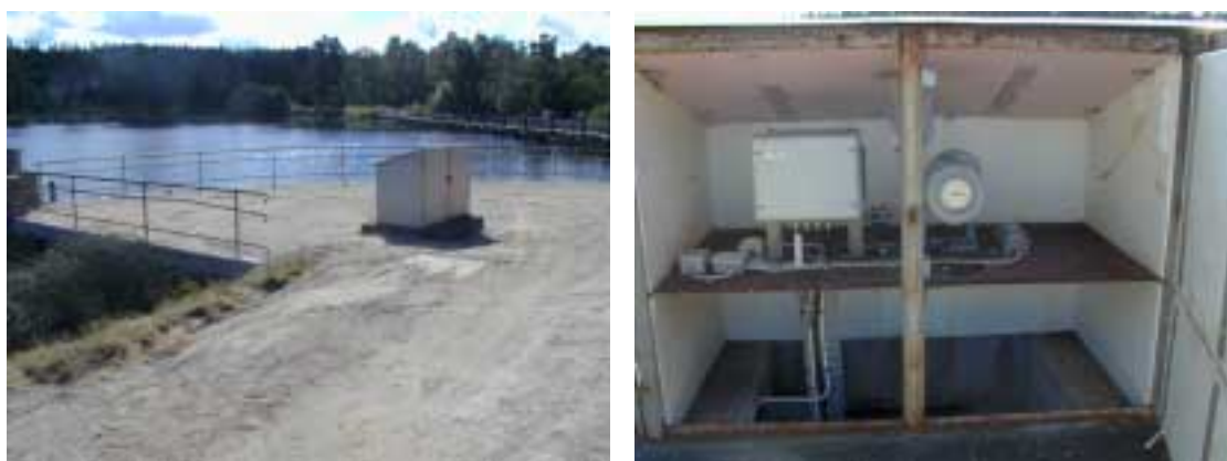
Figur 2.1. Pegelbrunn vid kraftstation överbyggd med ett skåp (vänster) i vilket mätutrustningen, en analog vattennivågivare av typen kapacitiv vinkelgivare, är placerad (höger).
