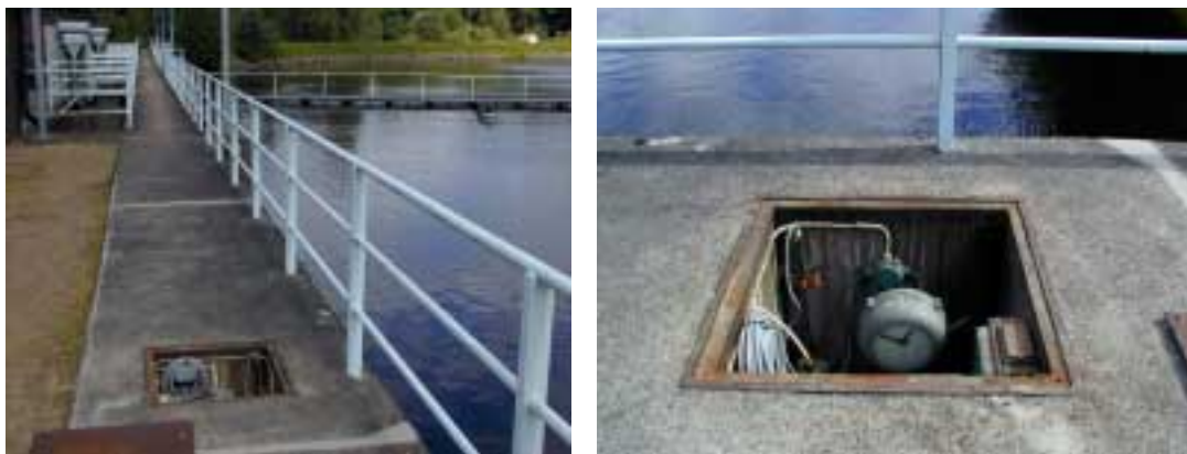
Figur 2.2. Pegelbrunn i kröndamm vid kraftstation (vänster). Mätutrustning placerad i brunnen (höger).
