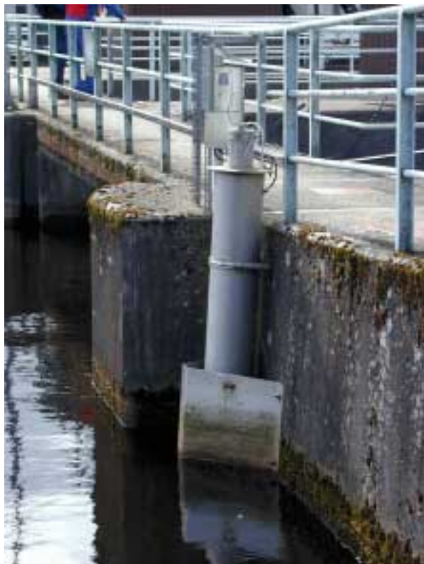
Figur 2.3. Rörkonstruktion, för vattennivåmätning monterad på kröddamm vid kraftstation.
