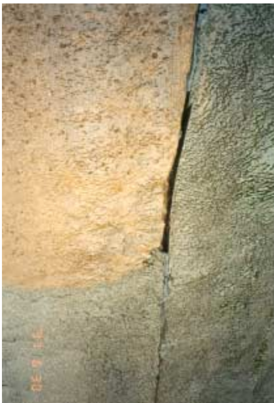
Bild 3.1.2. Fog mellan densit och sprutbetong – skibord A-B.
