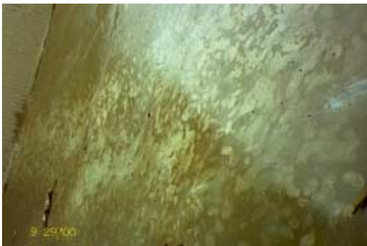
Bild 3.2.3. Färgskiftningar i ytan.
