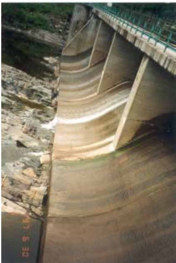
Bild 3.1.1. Utskovet vid Edsvalla kraftstation – fr.v. skibord A, B, C och D.
