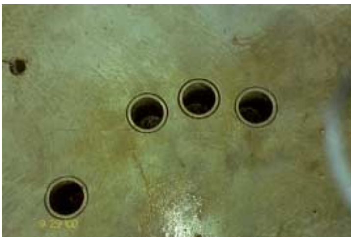
Bild 3.2.4. Färgskiftningar i ytan.
