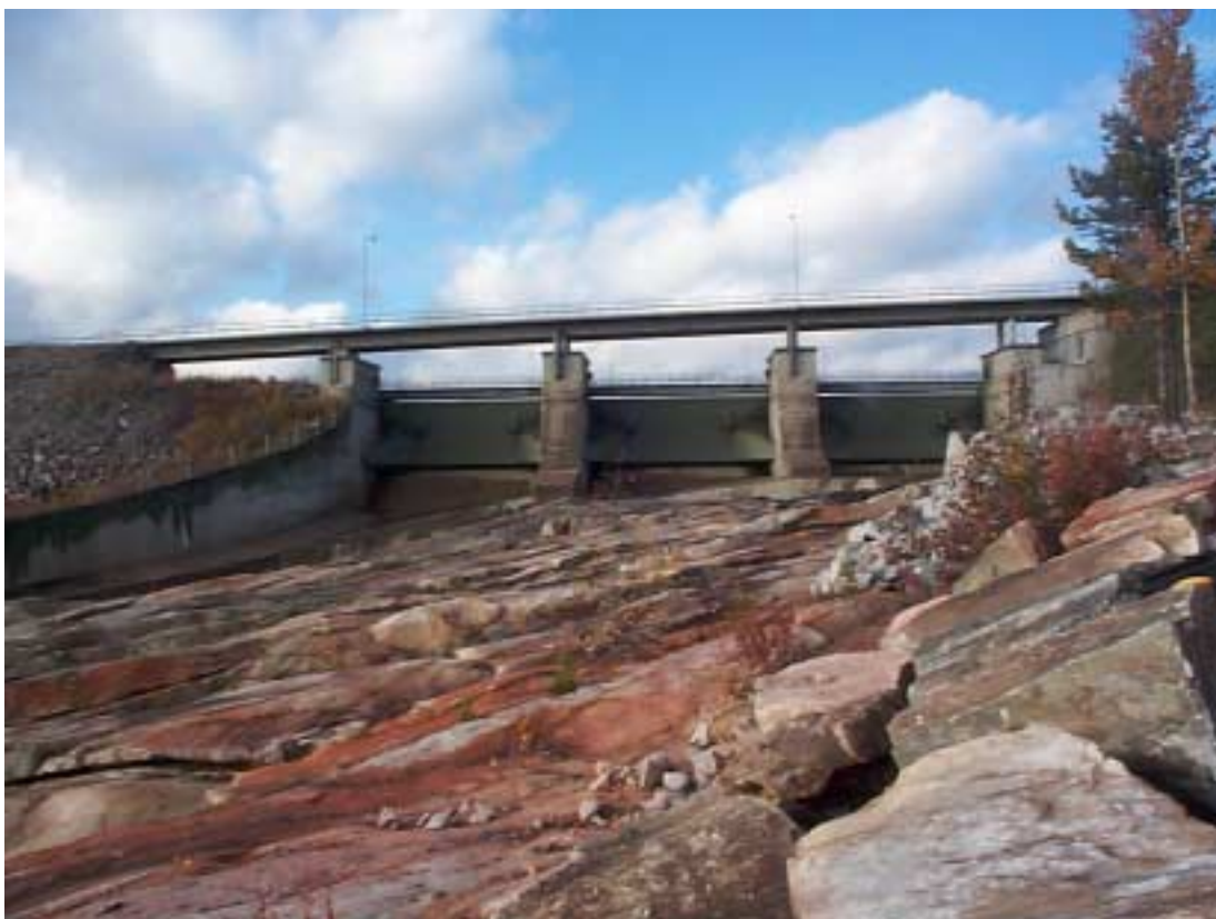
Bild 3.2.1. Utskov vid Ligga kraftstation – fr.v. skibord A, B och C.
