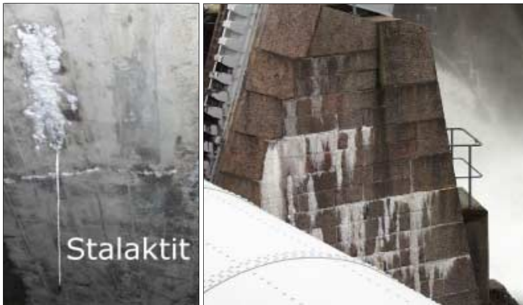
Figur 2.4 Två exempel på cementurlakning. I den vänstra bilden har kalk, som i lösning transporterats ut genom en spricka i betongen (en sluttande vägg), lösts ut vid kontakt med luftens syre och bildat en stalaktit. I den högra bilden har läckage skett genom otäta fogar i en betongpelares steninklädnad.
