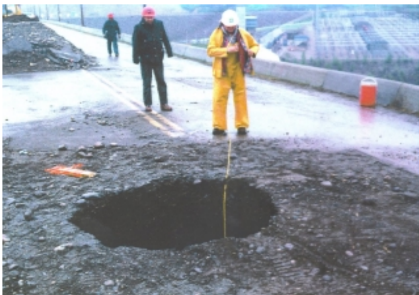
Figur 4 Bennett Dam – Sjunkgrop i krön på dammen
