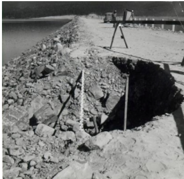
Figur 9A Sjunkhål i sektion 1/737 augusti 1963 / Sink-hole at section 1/737 August 1963
