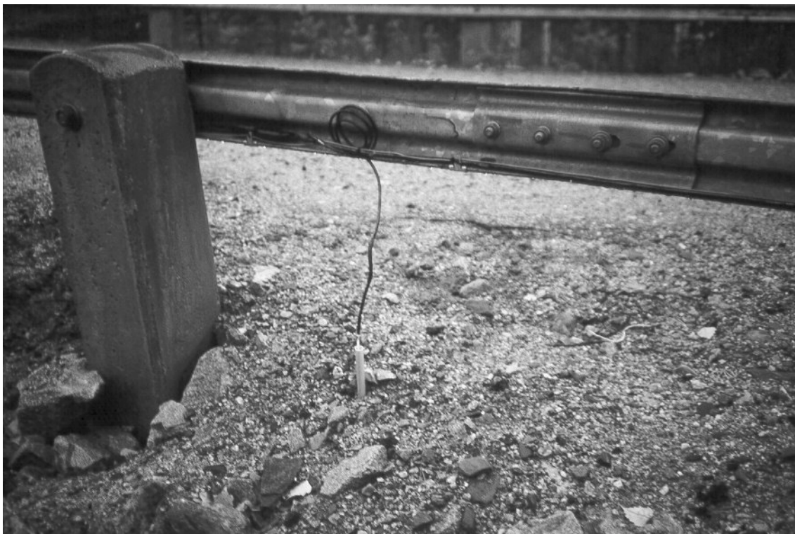
Figur 50. Anslutning mellan elektrod kabel lagd i vägräcket och nedgrävd elektrodplatta på höger dammkrön.
