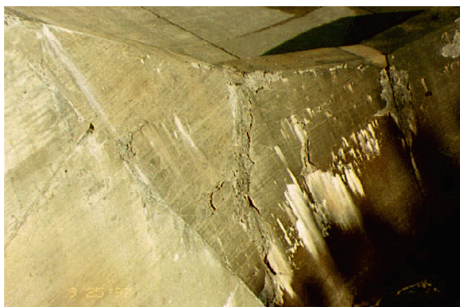
Figur 5.1 Exempel på avskalning orsakat av frostangrepp.
