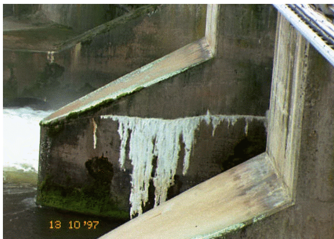
Figur 5.2 Exempel på spricka med läckage och kalkutfällningar.
