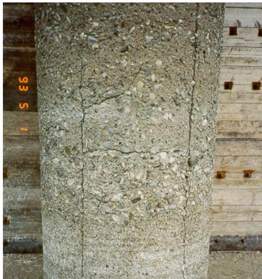
Figur 5.6 Exempel på hur AKR angrepp kan gestalta sig. Bilden visar en pelare placerad uppströms.
