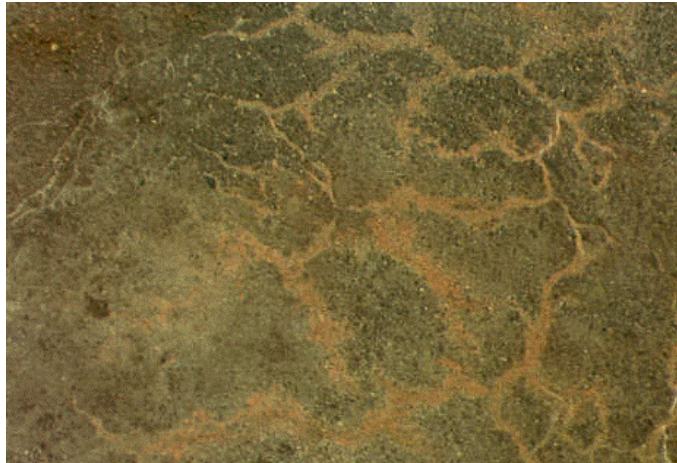
Figur 5.5 Exempel på hur AKR angrepp kan se ut på betongytan.
