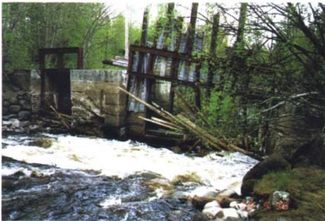
Bild 1a. Utskovet blockerat av stockar mm, som fastnat mot gåtarna. Vy från uppströms- sidan.
