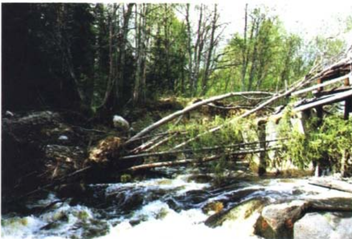
Bild 1b. Vattnet har eroderat en fåra vid sidan av betongfundamentet och därvid fällt ett träd.
