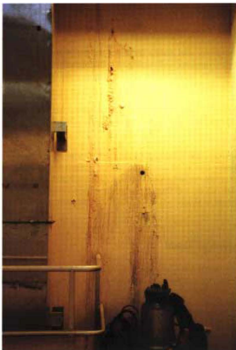
Fig 3.1. Framträngande vatten på vägg.
