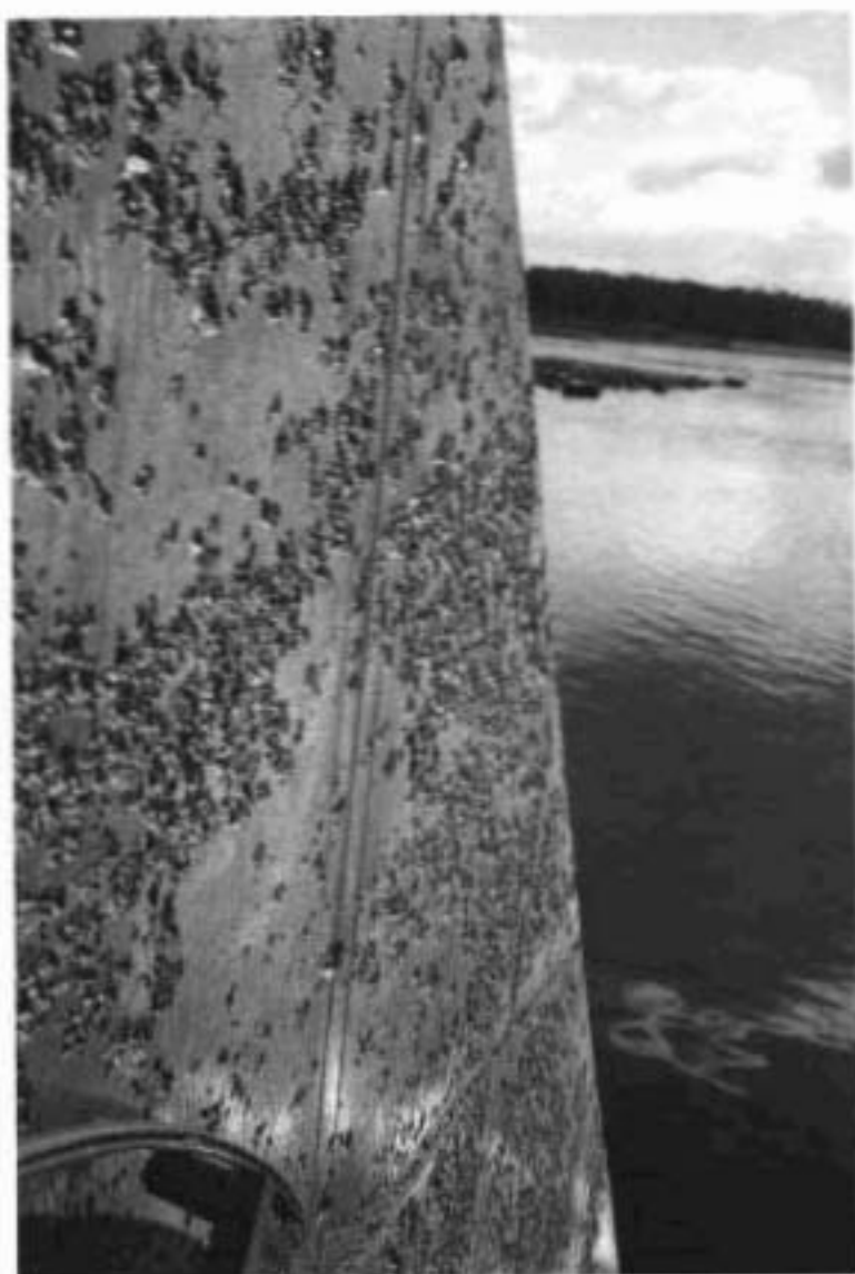
Fig 3.4. Avflagnings av material i ytan på en utskovspelare.
