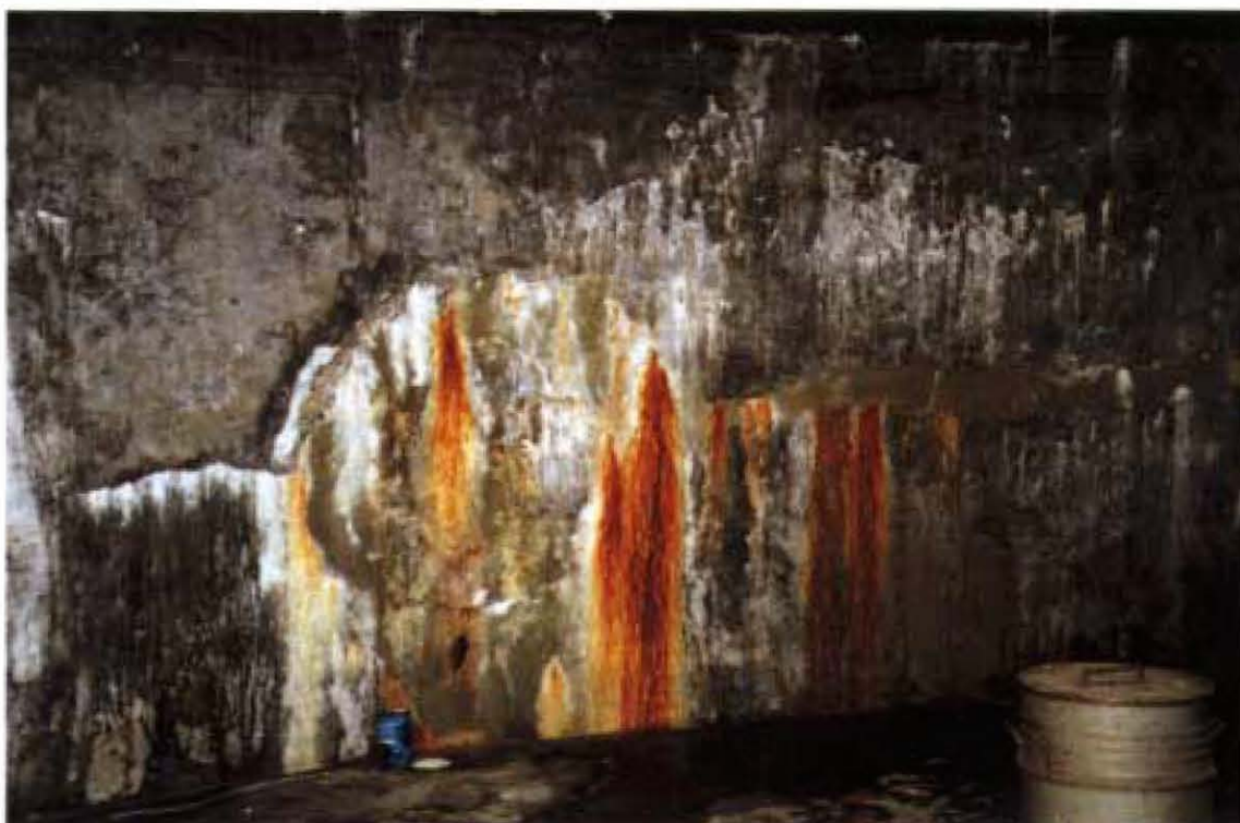
Fig 3.2. Kalkavlagringar på vägg.
