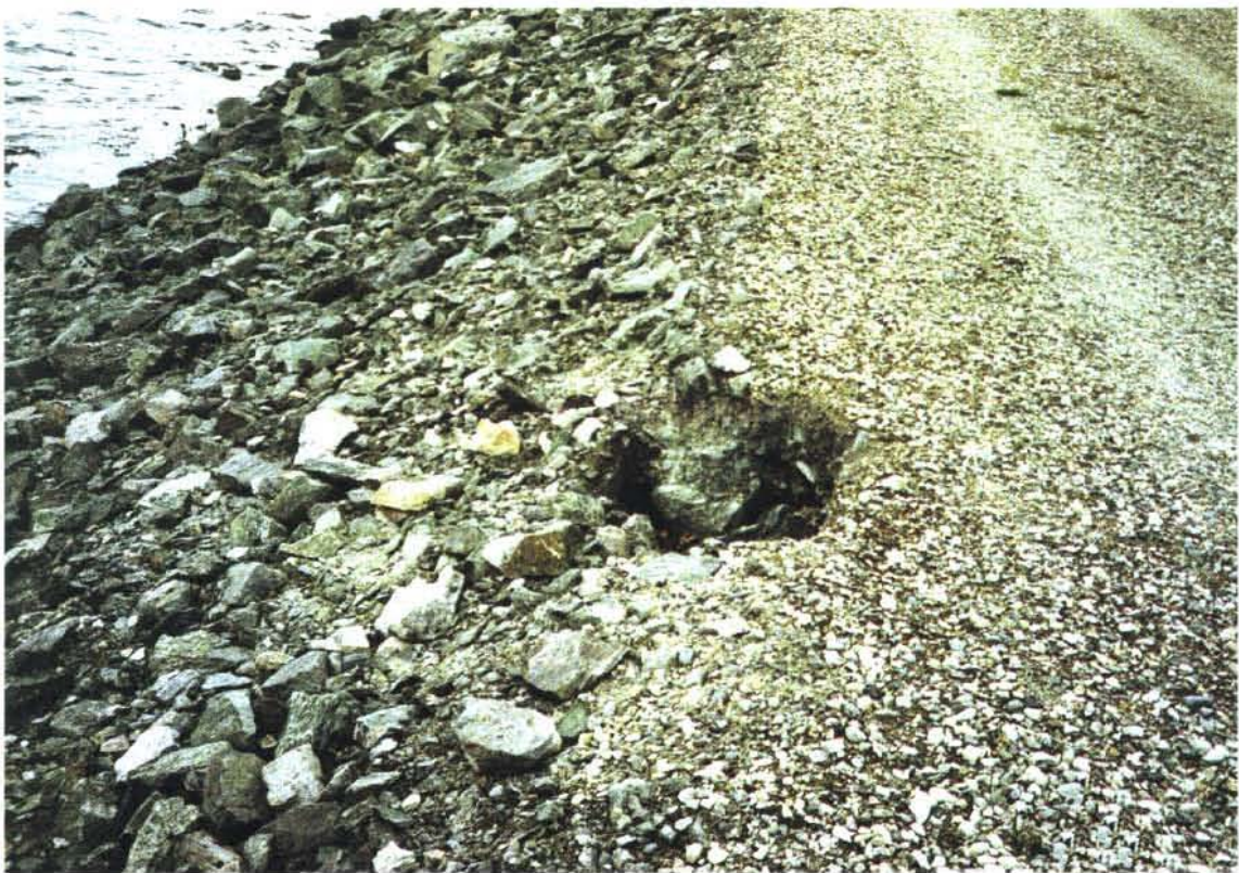
Figur 1. Erosionskanal vid spontspets (överst) och sjunkhål på dammkrönet (underst).
