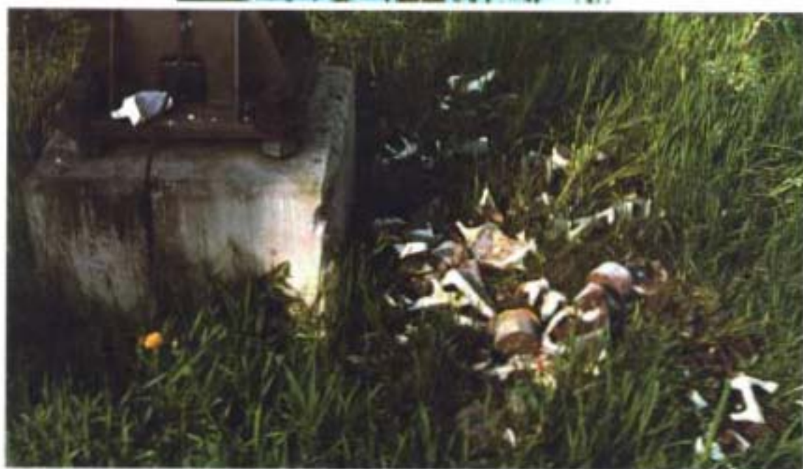
Figur 6.1. Ventilavledare för S-fasen har exploderat vid åsknedslag. Bilden avser påminna om risken för att ett åsknedslag orsakar fränslag i en kraftstation, varvid drivvattenföringen skall avbörjas genom utskoven. Det är naturligtvis då nödvändigt att utskovsfunktionen inte också slagits ut av åskan, dvs att kraftförsörjning, kontroll- och manöverystem har ett bra åskskydd.
