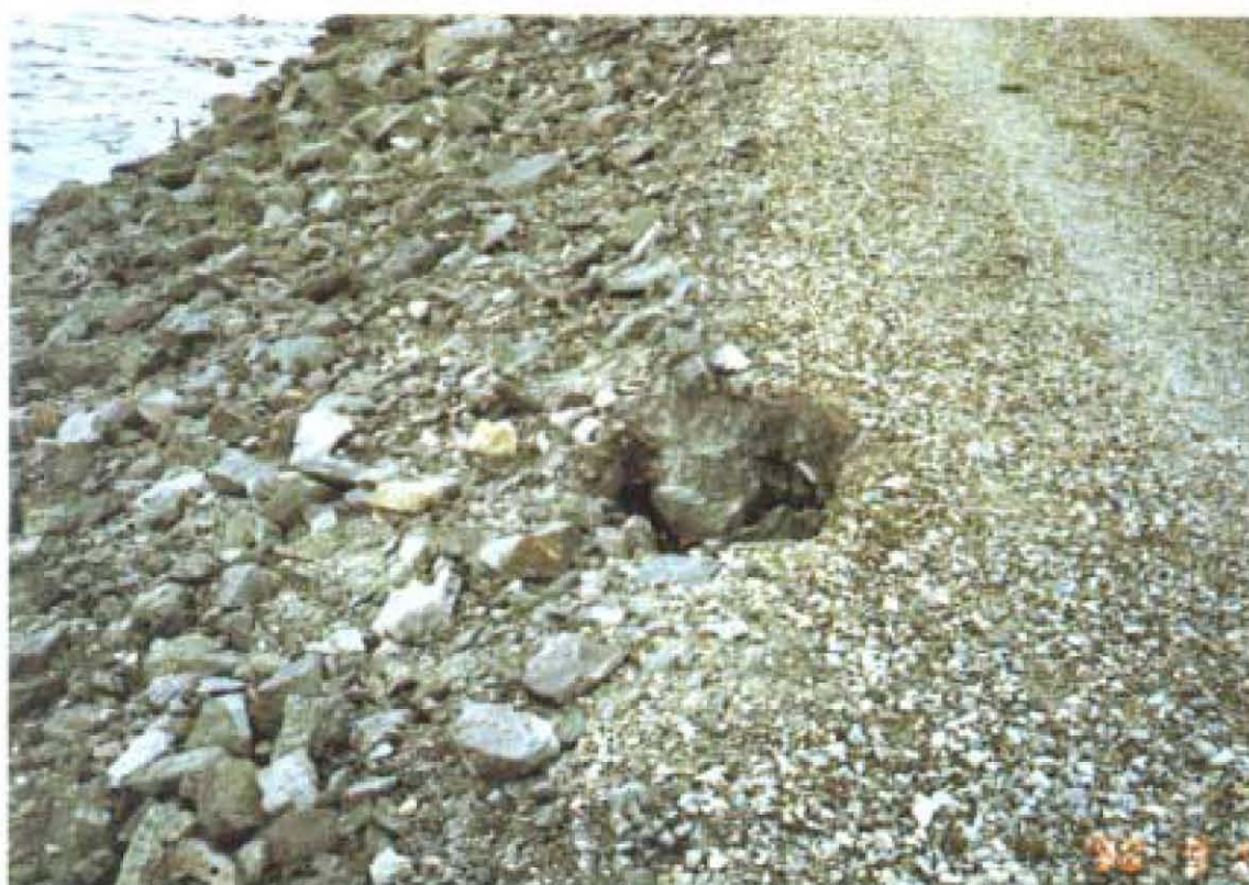
Figur 4.8. Erosionskanal vid spontspets (överst) och sjunkhål på damunkrönet (underst).
