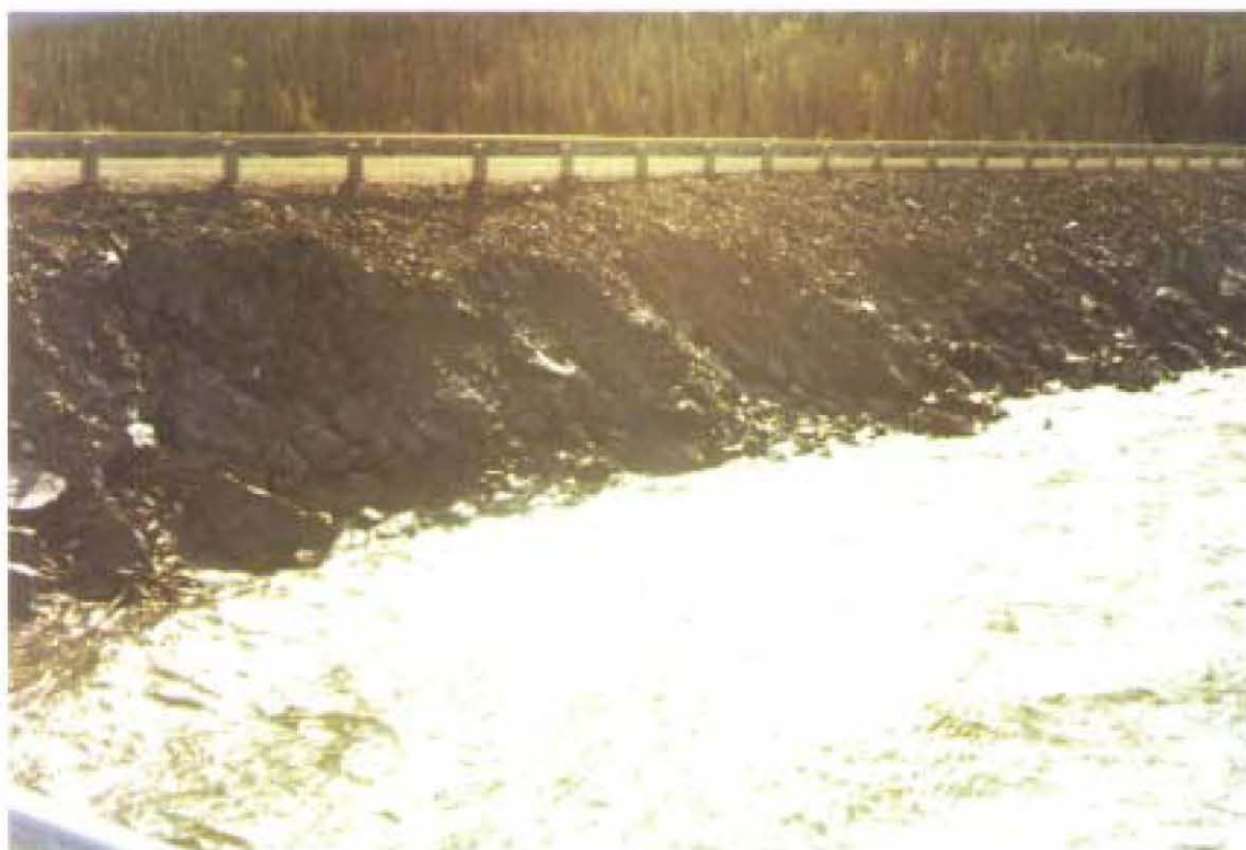
Figur 4.2. Skador i erosionsskydd.
