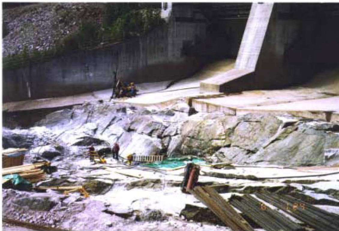
Figur 5.1. Reparation och förstärkning nedströms utskov på grund av berg som ryckts loss.
