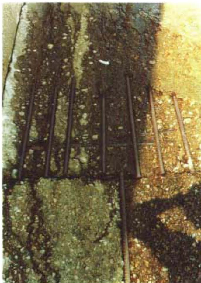
Fig 8.6. Skada på betong i utskov.
