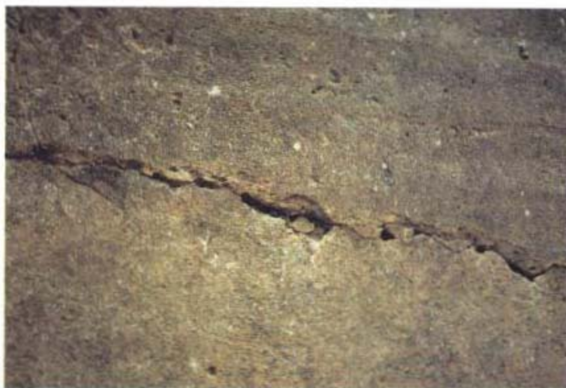
Fig 8.2. Porös betong i ytan på en kanalvägg vid en spricka.
