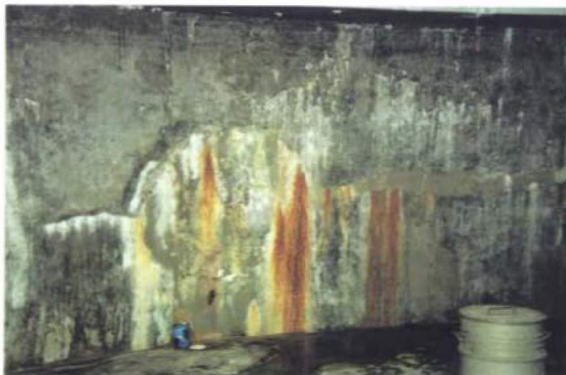
Fig 8.1. Kalkavlagringar på vägg.
