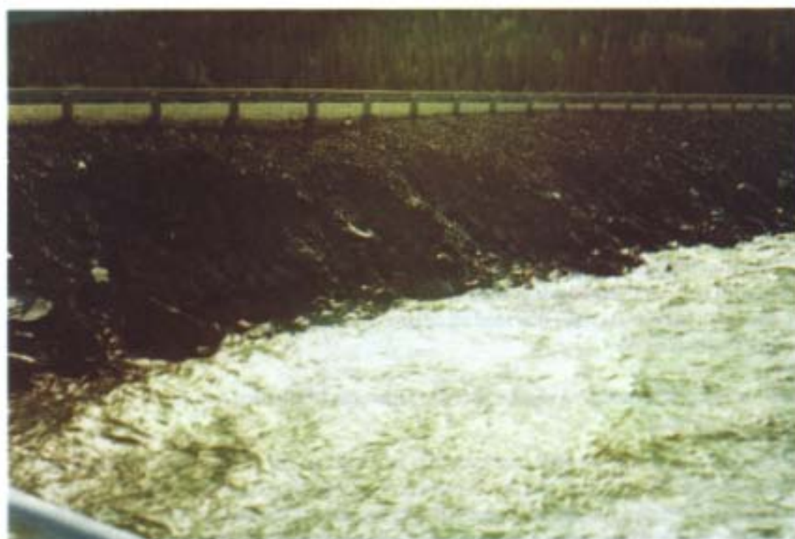
Bild 4.2. Skador i erosionsskydd.
