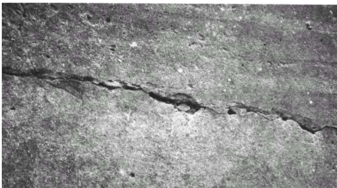
Figur 3.5. Schematisk skadebild av nedbrytning vid spricka.
