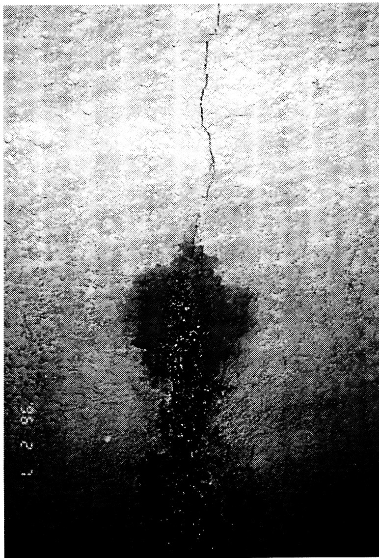
Figur 4.24 Sprickor i sprutbetong med stålfiberarmering, vägtrumma under E20 i Lerum.
