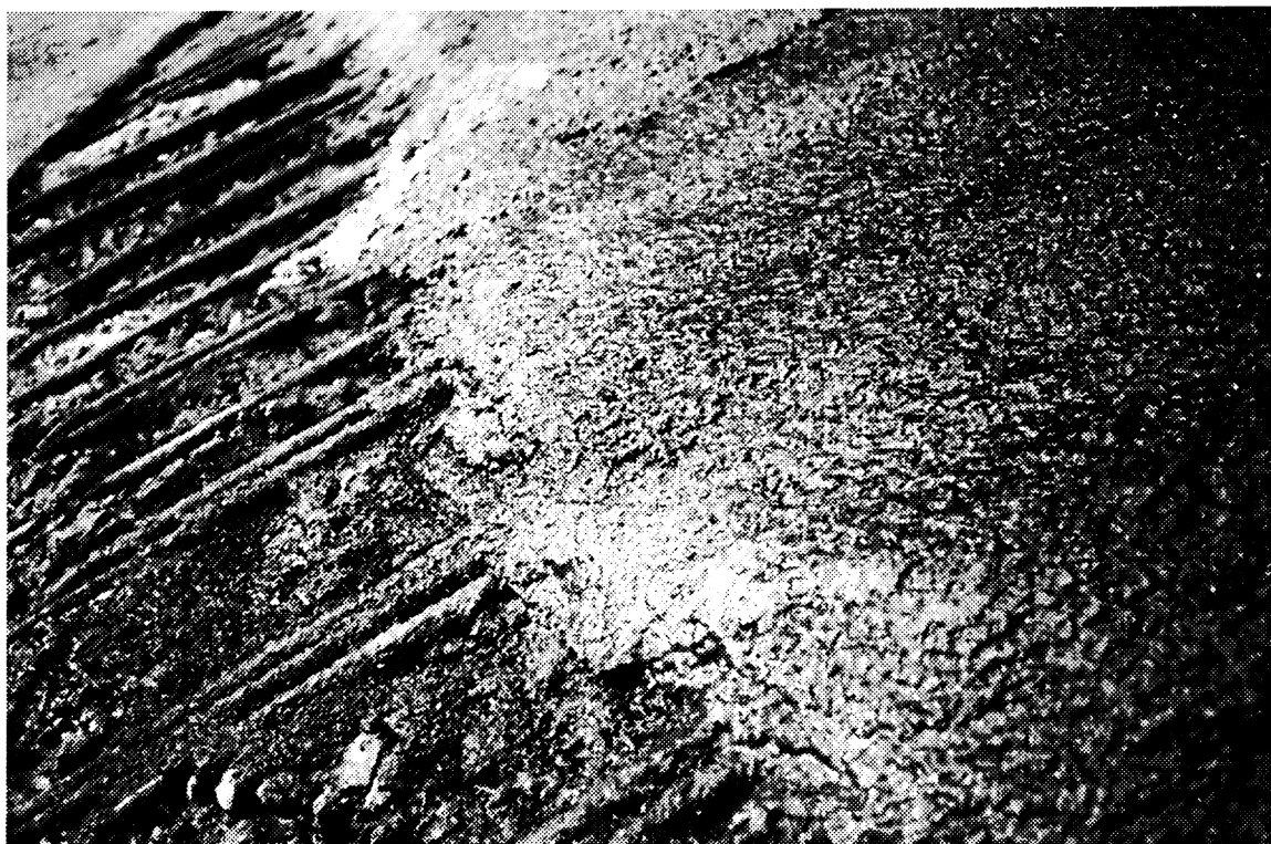
Figur 4.18 Utskov C Hölleforsens kraftstation, detalj av skada. Spillway C of the Hölleforsen power plant, detail of damage
