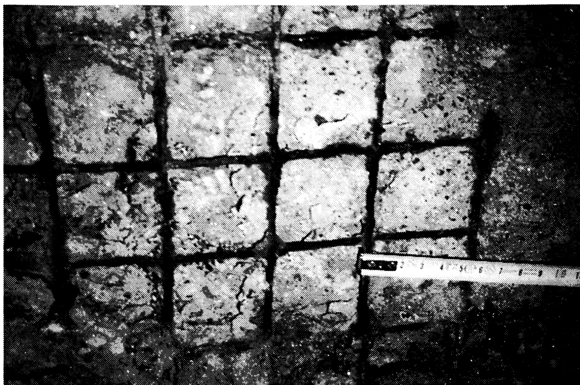
Figur 4.4 Detalj av skada i förskärning till tunnel i Graversfors. Detail of damage in open cut to the tunnel in Graversfors.
