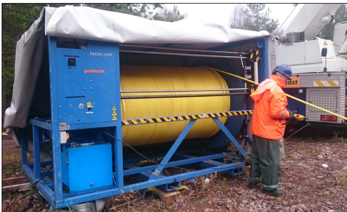
Figur 7.12 TMS med 7 km försörjningskabel.
