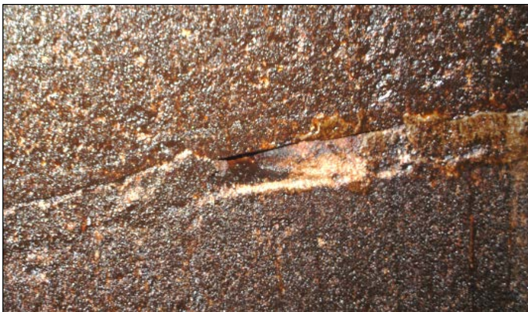
Figur 7.10 Erosionskada i tilloppstuben. Skadan är ca 300 mm bred, 100 mm hög och 150 mm djup.
