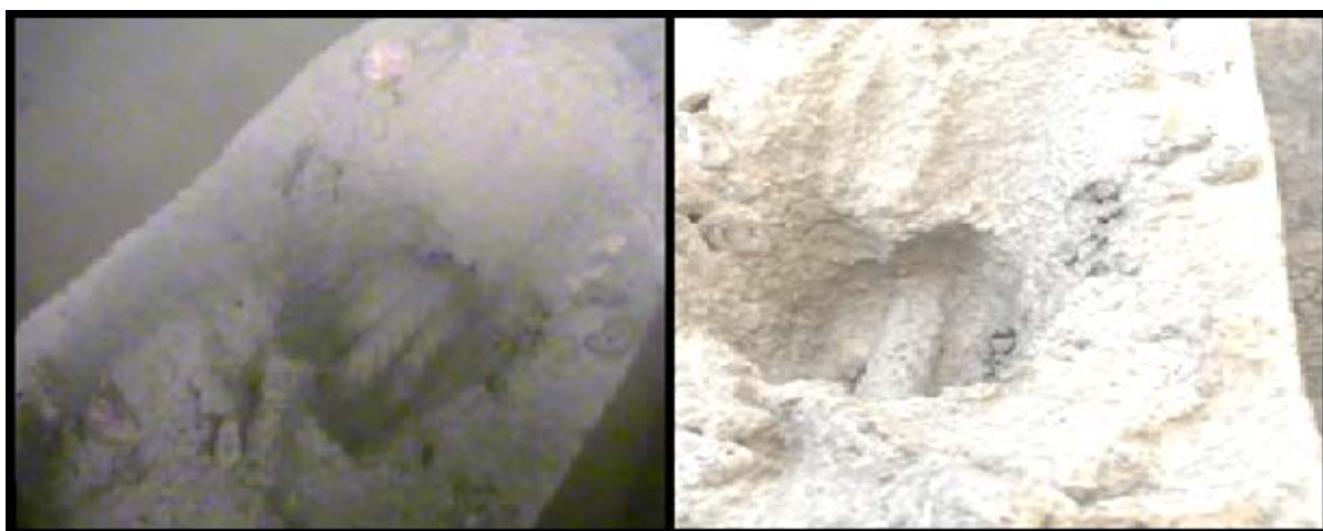
Figur 7.25 Balk 2 med tillverkad erosionsskada över armeringsjärn. T.v. foto från ROV och t.h. foto från torrhet.
