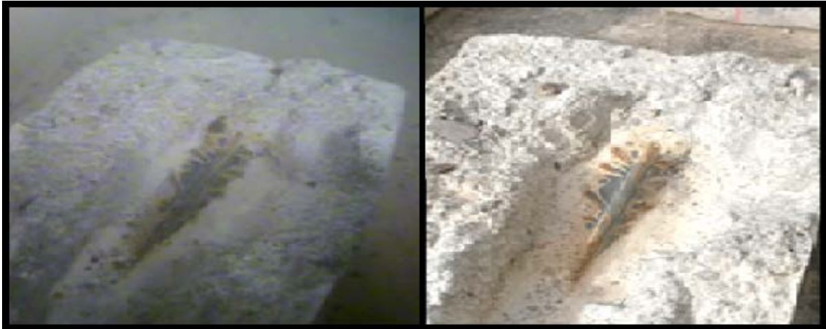
Figur 7.27 Balk 4 med tillverkad erosionsskada och ett armeringsjärn. T.v. foto från ROV och t.h. foto från torrhet.
