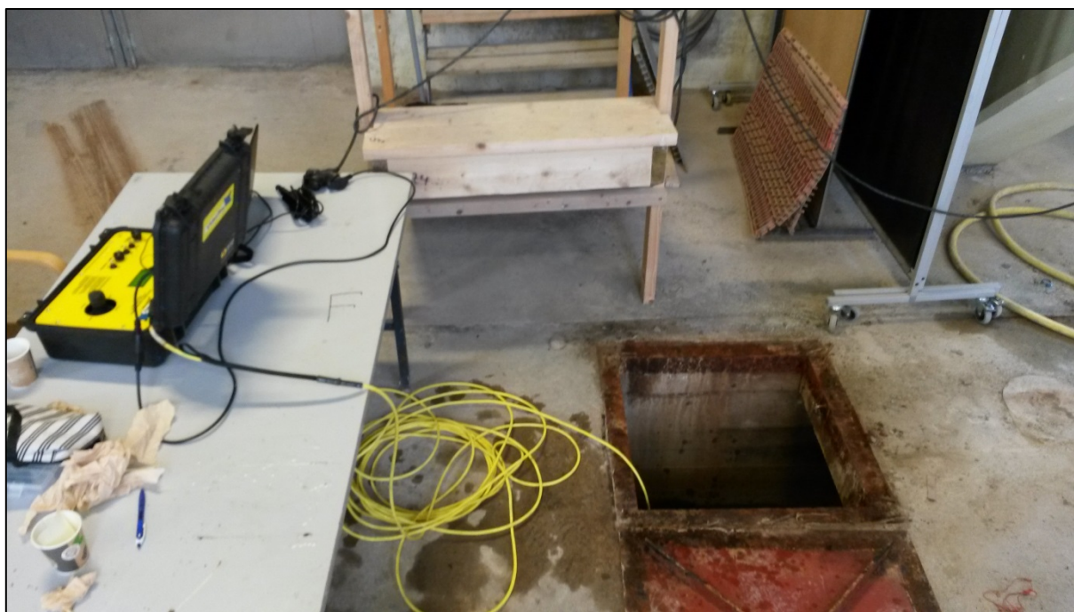
Figur 7.20 Kontrollstation och lucka i hallgolvet där ROV:en sänktes ned inför varje försök.
