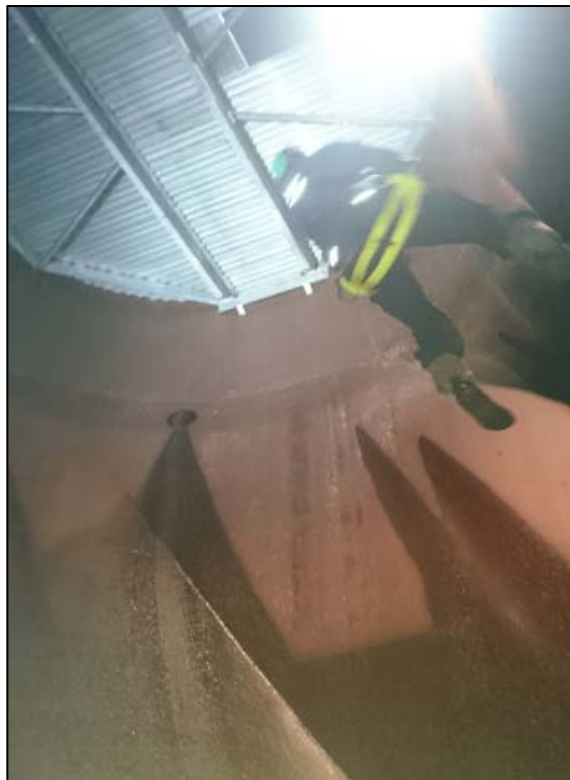
Figur 7.3 Drygt 20 meter från plattform till sugrörets botten. Ovan i bild syns plattformen som är monterad precis under turbinen.
