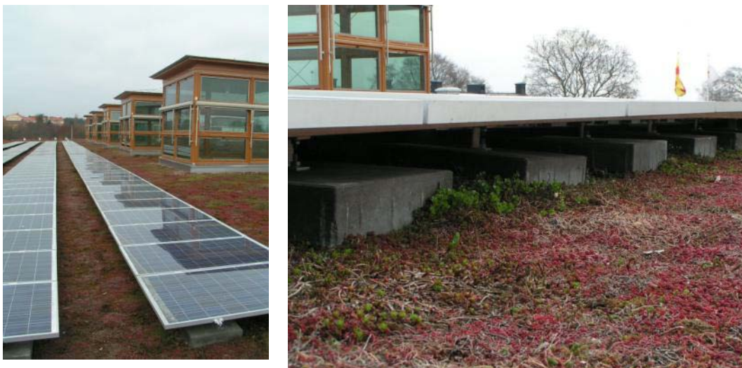
Figur 2.9 Liggande solceller installerade ovanpå sedumtaket på Linköpings bibliotek.
