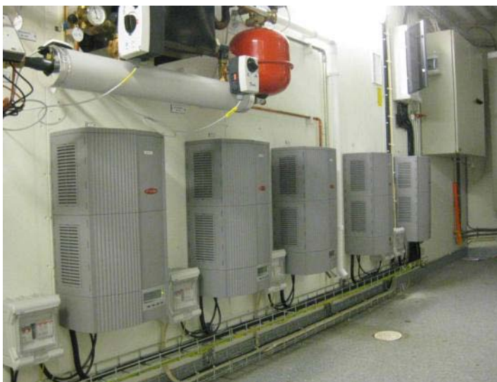
Figur 4.25 De fem växelriktarna konkurrerar med fjärrvärmen i teknikrummet med resultatet att arbetshöjden vid service är något låg.
