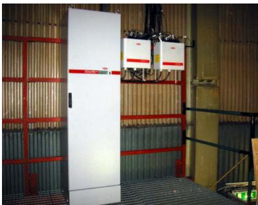
Figur 4.7 Växelriktaren och de två "string controllers".
