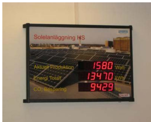
Figur 4.5 Aktuell effekt och ackumulerad energiproduktion visas på en tavla på entréplanet. Tavlan visar även den besparing i form av CO 2 , som anläggningen har bidragit till.
