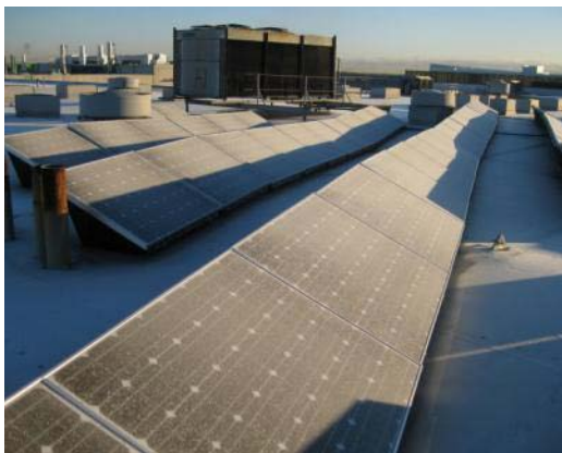
Figur 4.1 De 78 modulerna, med mono-kristallina kiselceller, är tillverkade av det japanska företaget Sharp. Modulerna är monterade med lutningen 25° mot söder.
