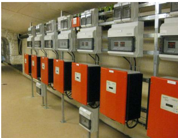
Figur 4.18 De 9 växelriktarna kommer från SMA, SB4200TL och SB5000TL.
