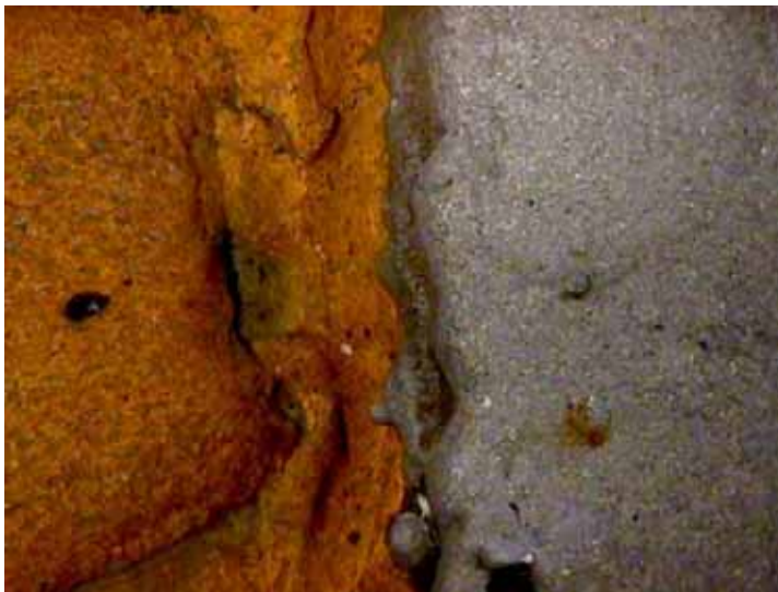
Figur 1.5–20. Exempel på galvanisk korrosion mellan kolstål (anod) och rostfritt stål (katod) [DNV AB].
