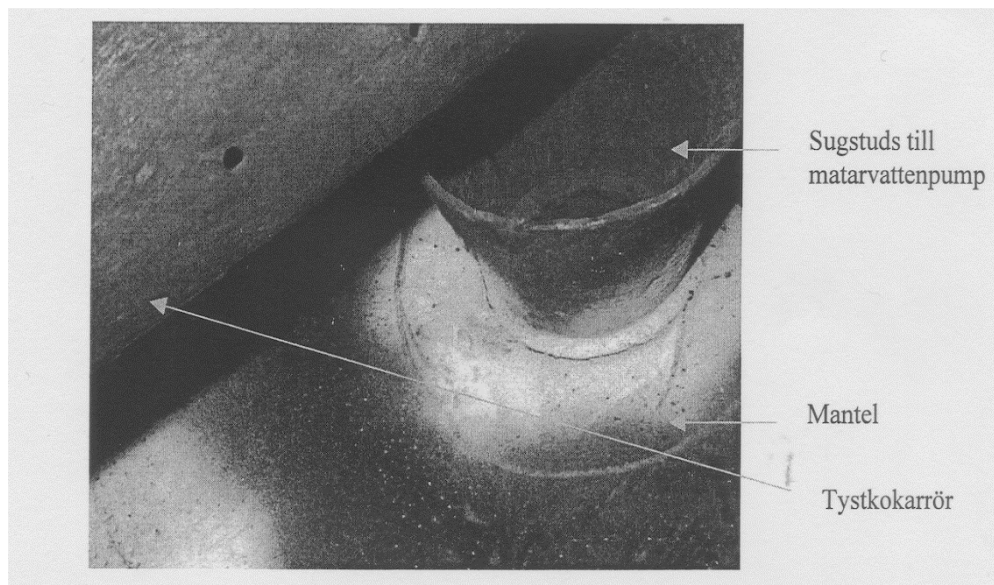
Figur 2.4-7. Sprickbildning i svets mellan sugstuds och mantel.
