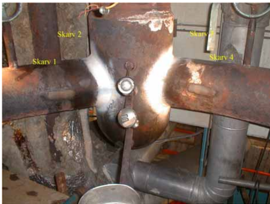
Figur 1.8-11 Formstycke i en huvudångledning. Sprickor hittades i svetsskarv 3 och 4.
