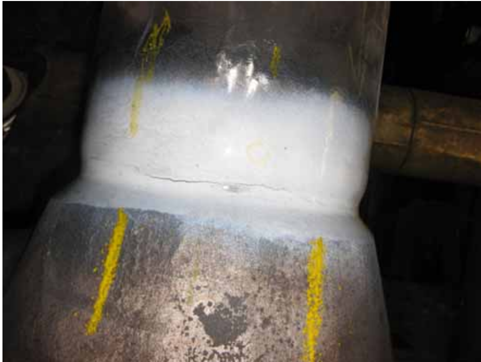
Figur 1.6-2. Krypsprickor detekterade med MT
