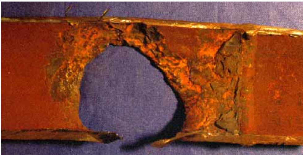
Figur 1.5–15. Ett exempel på avlagringskorrosion. Bakom en svets har en avlagring bildats med en koncentrationscell och korrosion som följd. Bilden visar korrosionsskadan sedan avlagringen avlägsnats [ÅF-IPK AB].
