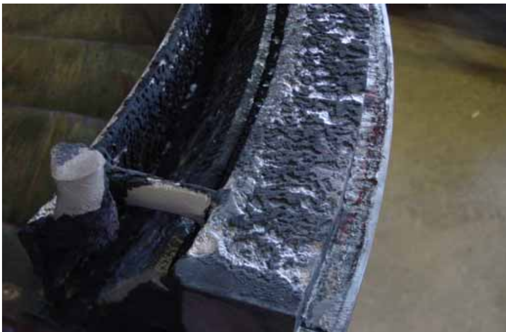
Figur 20 Erosions-korrosion i mellanvägg MT9
