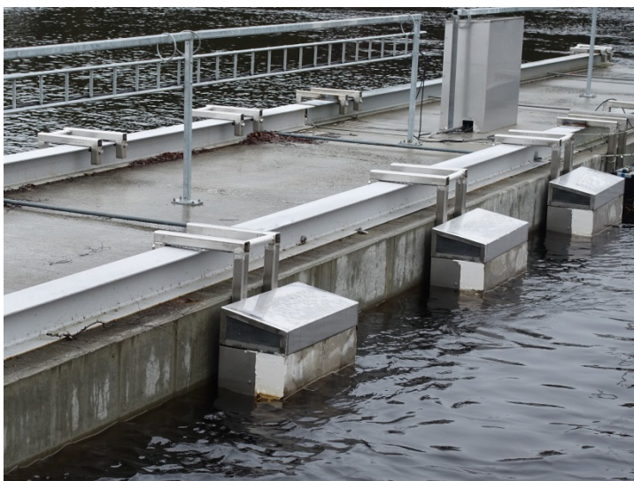
Fig. 3.18. Fogbandsprovkroppar monterade på fältstationen
