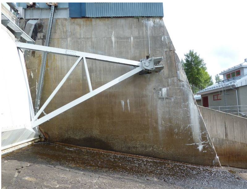
Figur 2-9 Utskovspelare skadad av AKR, frost, och urlakning.
