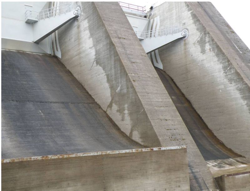
Figur 2-8 Sprickor i utskovspelare.
