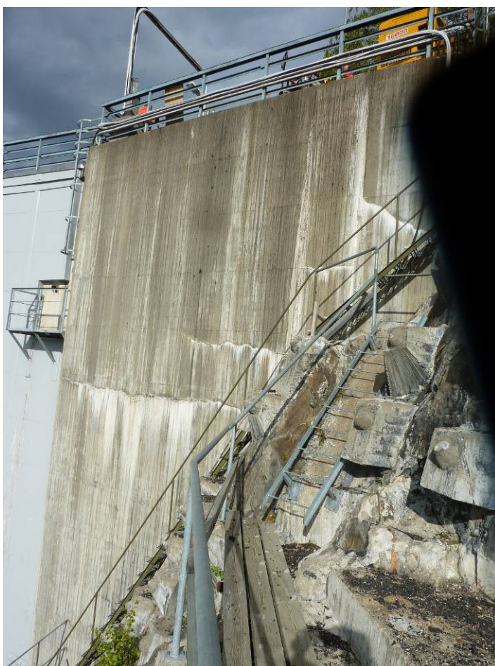
Figur 2-7 Sprickor i ett anfang till en valvdamm.
