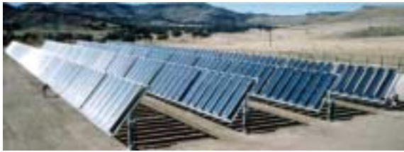
Figur 8: ENTECH's 100-kilowattsystem med fresnellinser i Fort Davis, Texas.
