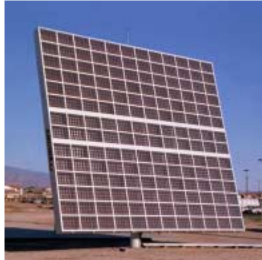
Figur 7: 18-kW p Amonix Megamodule med fresnellinser som ägs av Nevada Power Company i Las Vegas, USA.
