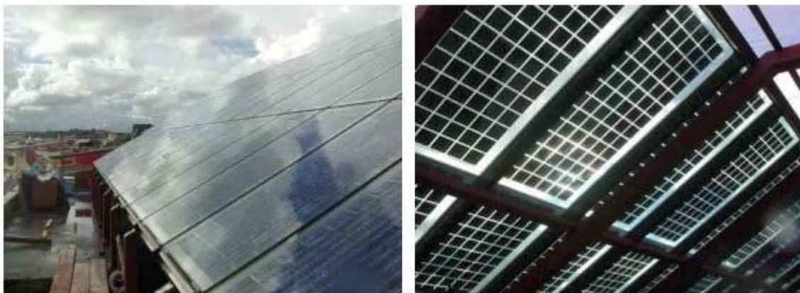
Figur 10.9. Solcellsanläggning Hammarby Sjöstad, Stockholm; JM:s hus
