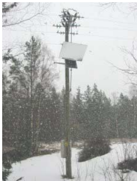
Figur 9.5. Fullständig reflektorinstallation på frånskiljarstation i Ängskär
