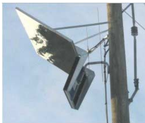
Figur 9.2. Detaljbild över reflektormontaget på kraftledningsstolpe i fränkskiljarstation. Till höger om stolpen syns delar av länketaget för manövrering av fränkskiljaren.
