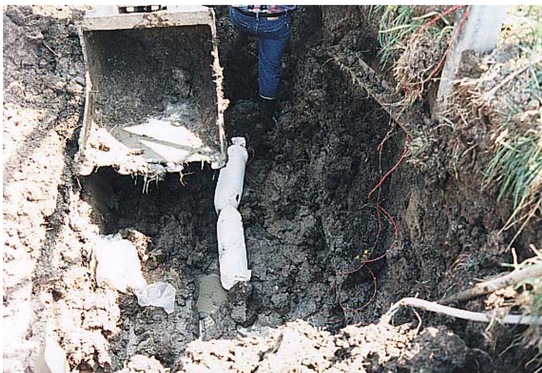
Fig. 4. Två magnesiumanoder kopplade i serie nergrävs vid stolpfundament.
