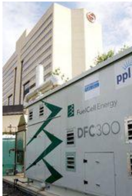
Fig. 3. Installation av FCEs system DFC300 vid ett Hotel Sheraton i USA.
