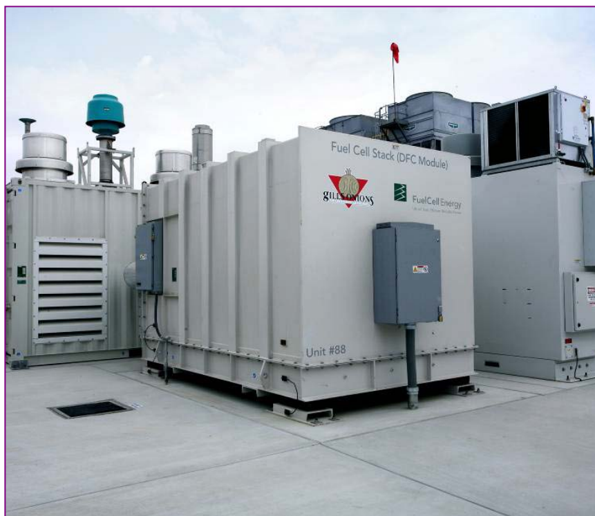
Fig. 4. Fuel Cell Energy's installation av MCFC hos företaget Gills Onions. [www.fuelcellenergy.com]
