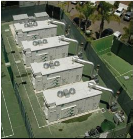
Figur 3-7. 1 MWe bränslecellsanläggning vid ett hotell i Kalifornien.
