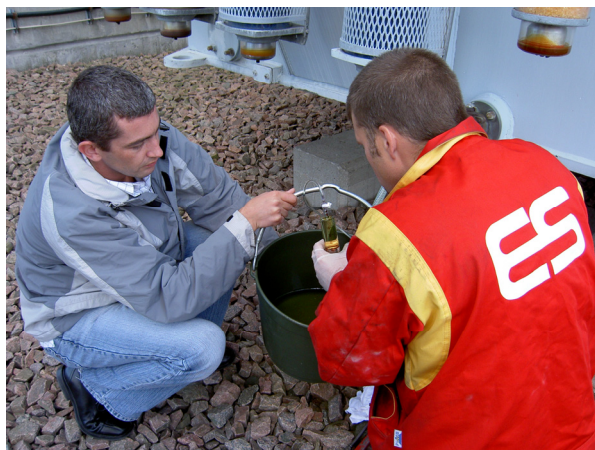
Figur 19 Provtagning från Transformator D
