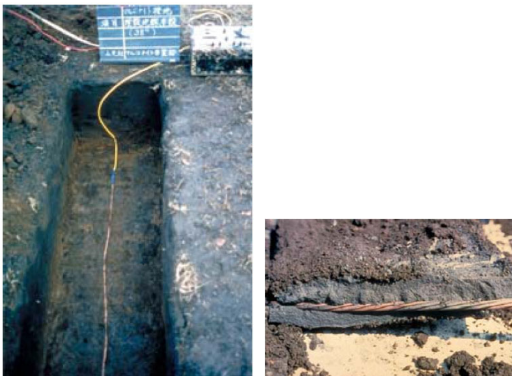
Figur 9 Läggningslinan (koppar) i ledande betong och närbild av inbäddad jordningslina (Sanearth Technical Review, (58))
