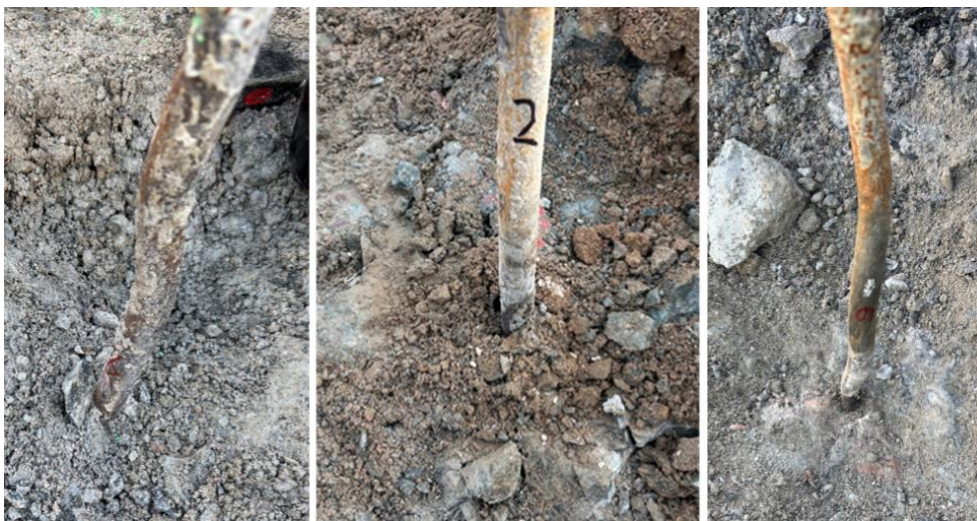
Figur 10. Bilder på bergförankring 18, 20 samt 21 som samtliga gått till brott i injekteringsbruket.
