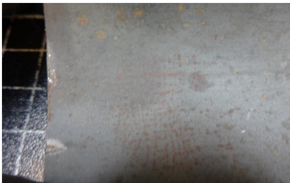
Bild 11:3. Korrosion och eventuella sprickor i området där svetsning börjar och slutar.
