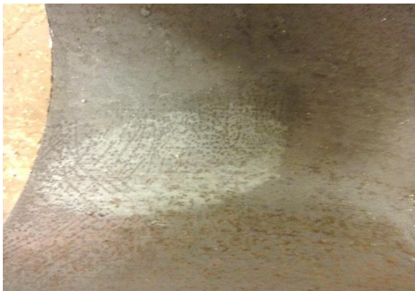
Bild 7:3. Utseende hos insida. 45°-sprickor samt märkbar värmepåverkan.
